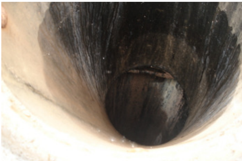
Kuva 12. Teleskooppiputki vinossa ja tiiviste pois paikoiltaan
