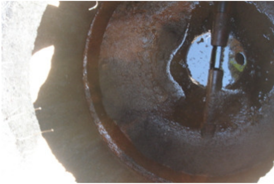
Kuva 7. Vuotava saostuskaivo, jossa epäyhtenäinen viemäriputki
