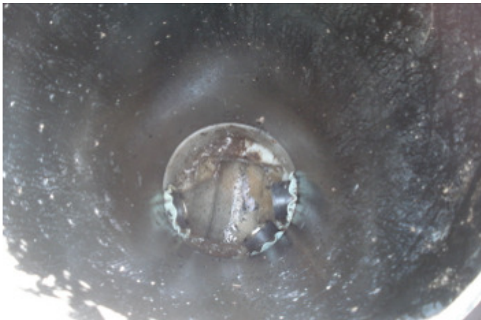
Kuva 8. Saneerauskaivon tiiviste pois paikoiltaan
