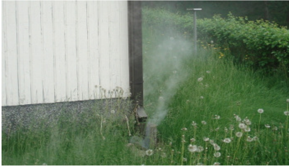
Kuva 14. Savua purkautuu rännikaivosta
