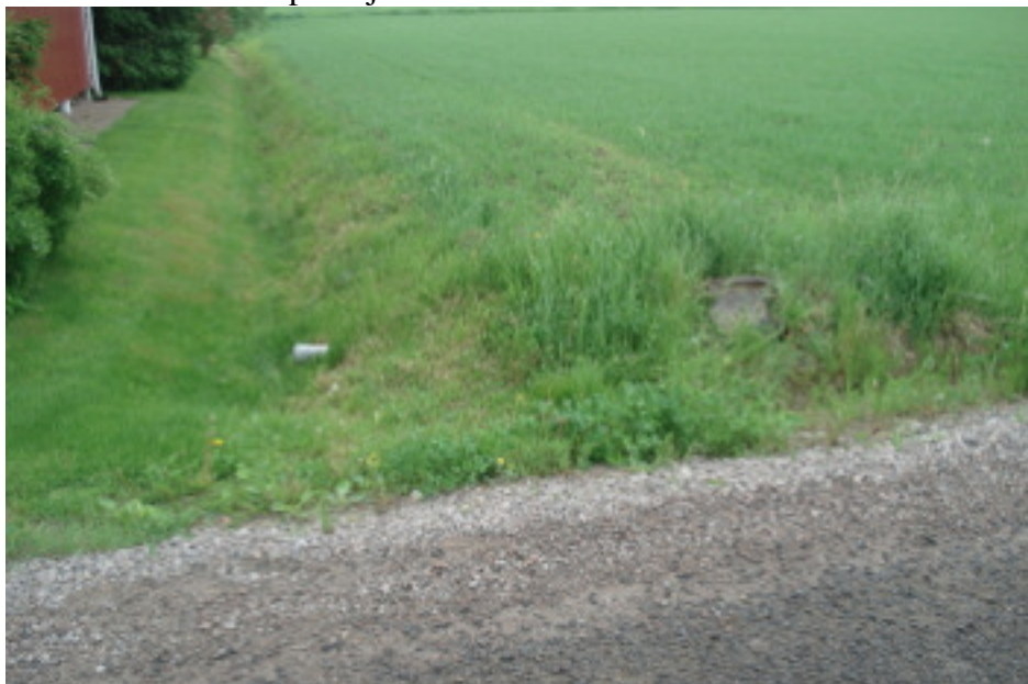
Kuva 14. Pumppaamon tulokaivon ylivuoto ojan pohjalla
