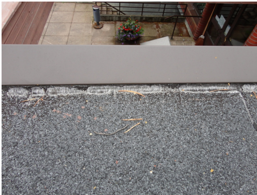
Kuva 2. Bitumihuovassa kulumisen merkkejä (Valokuva Halsas 2012.)
