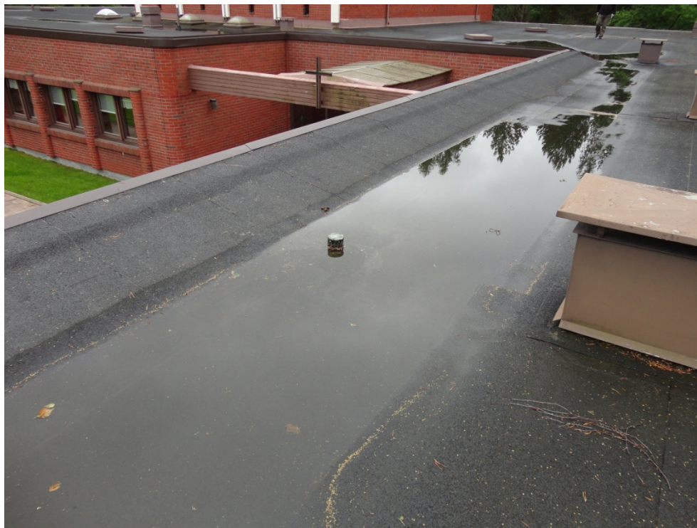
Kuva 3. Bitumihuopakatteen vedenpoiston ongelmia (Valokuva Halsas 2012.)
