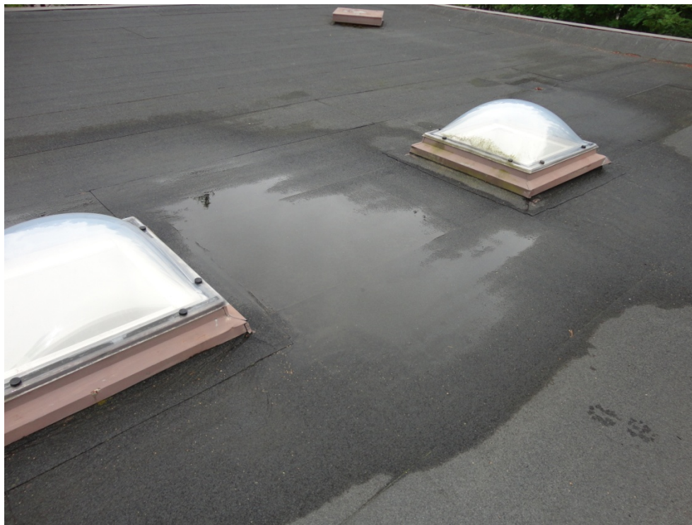
Kuva 13. Kattoluukkujen ja -ikkunoiden ylösnostot ovat puutteelliset (Valokuva Halsas 2012.)
