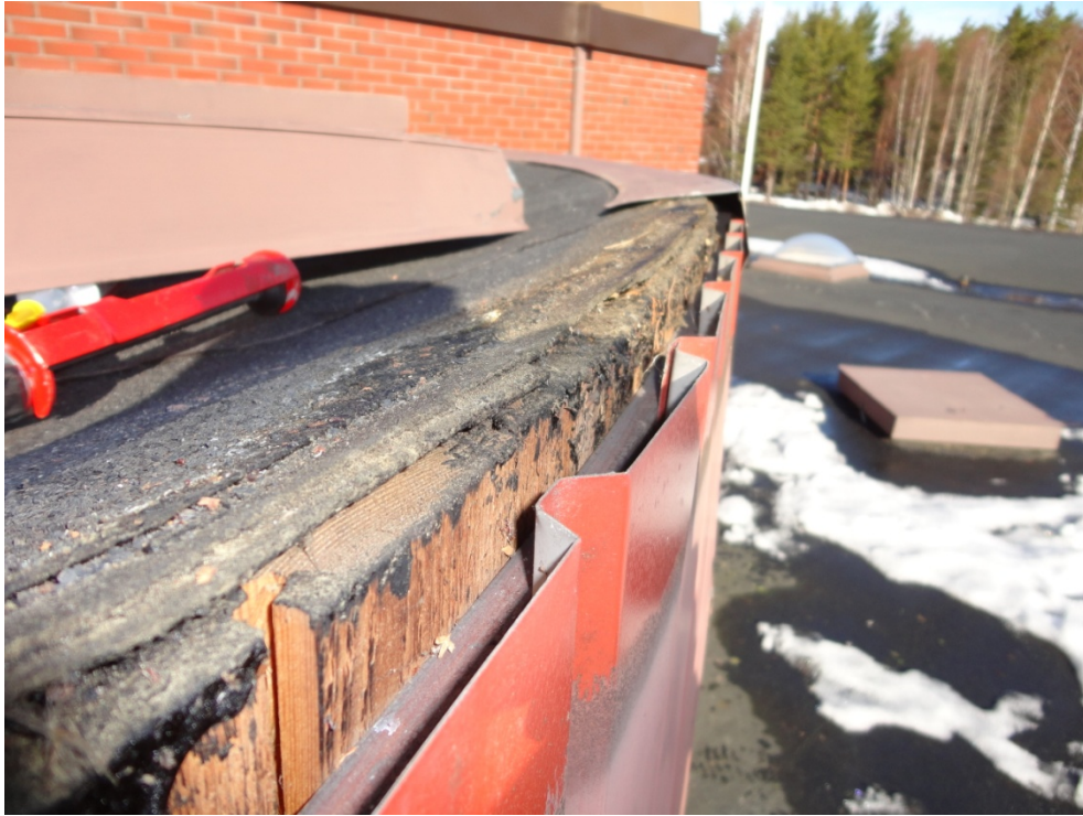
Kuva 8. Juhlasalin katon ongelmallinen räystäärakenne (Halsas 2012-07-17.)
