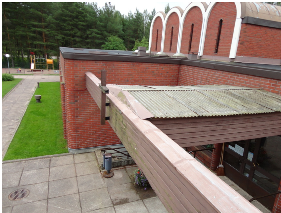
Kuva 12. Pääsisäänkäynnin katoksen puuosat kaipaavat huoltoa (Valokuva Halsas 2012.)
