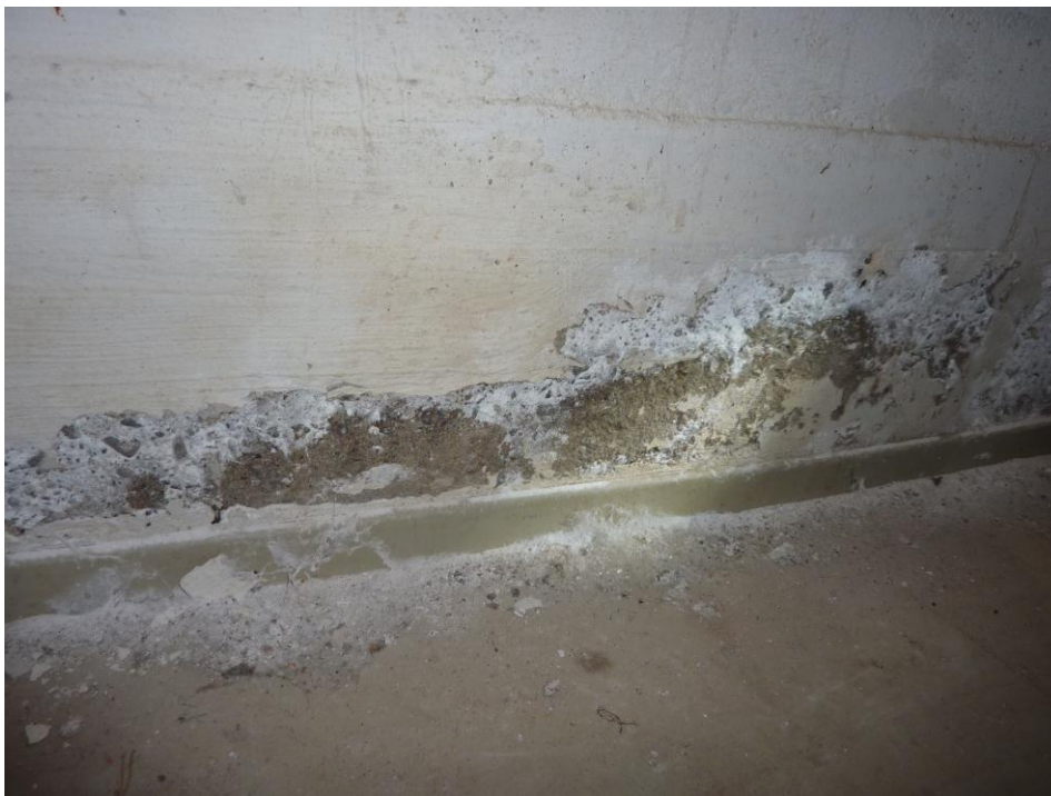
Kuva 3. Vaurioita kellarin seinässä (Kuvannut: Aleksi Salminen).
