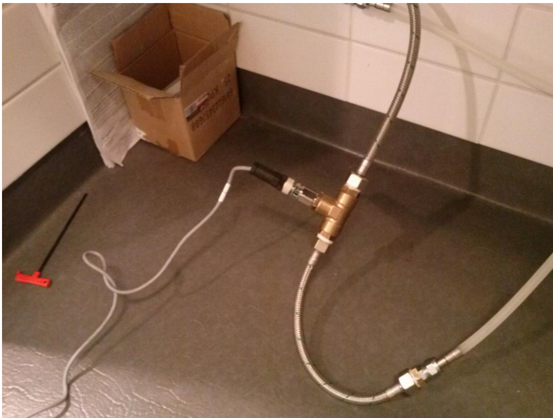
Kuva 6. Paineanturi Trafag 8822 asennettuna hanan alapuolelle
