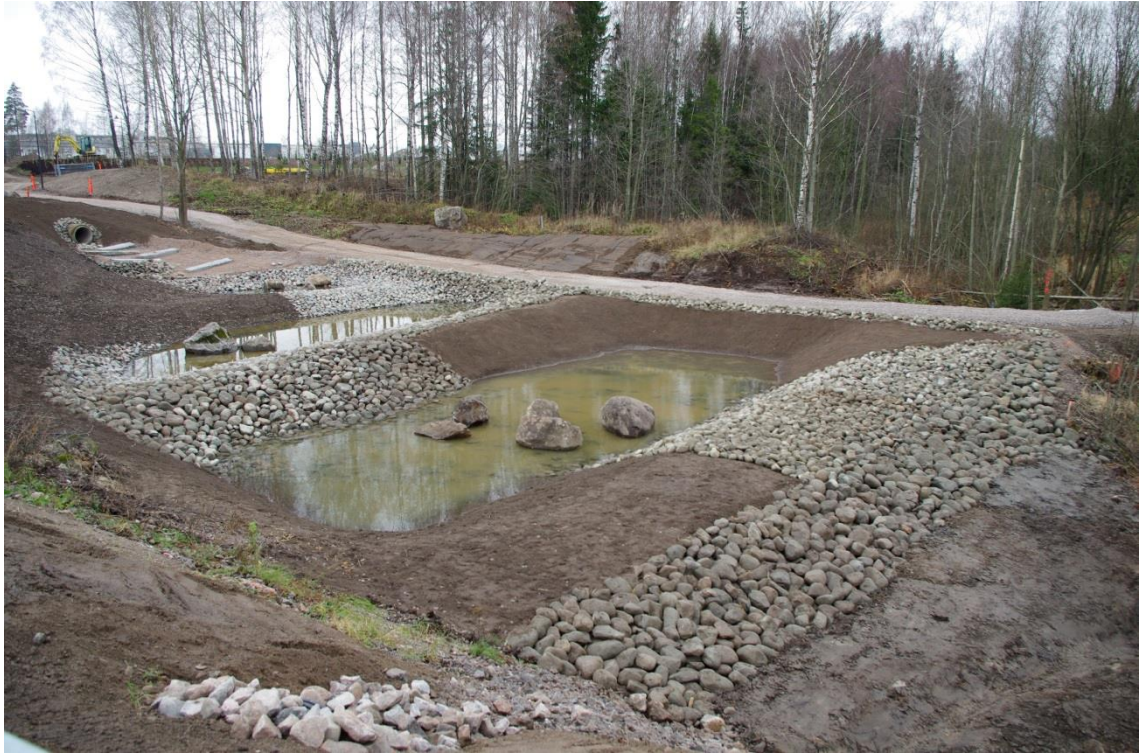
KUVA 3. Hulevesijärjestelmän viivytyksaltaita Kehä 3 vieressä sijaitsevassa Osumapuistossa (Kuva: Aleksi Martikainen)
