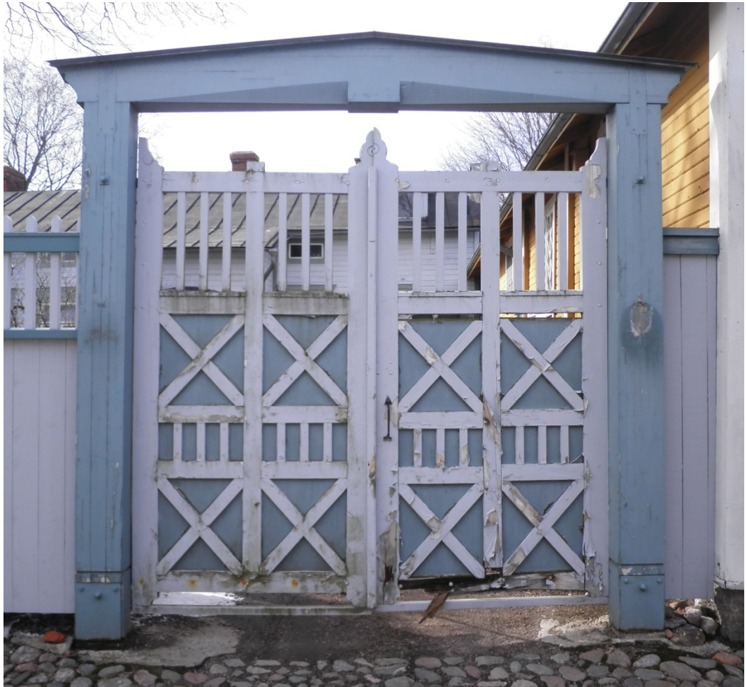
KUVIO 39. Pahasti vaurioitunut portti.
