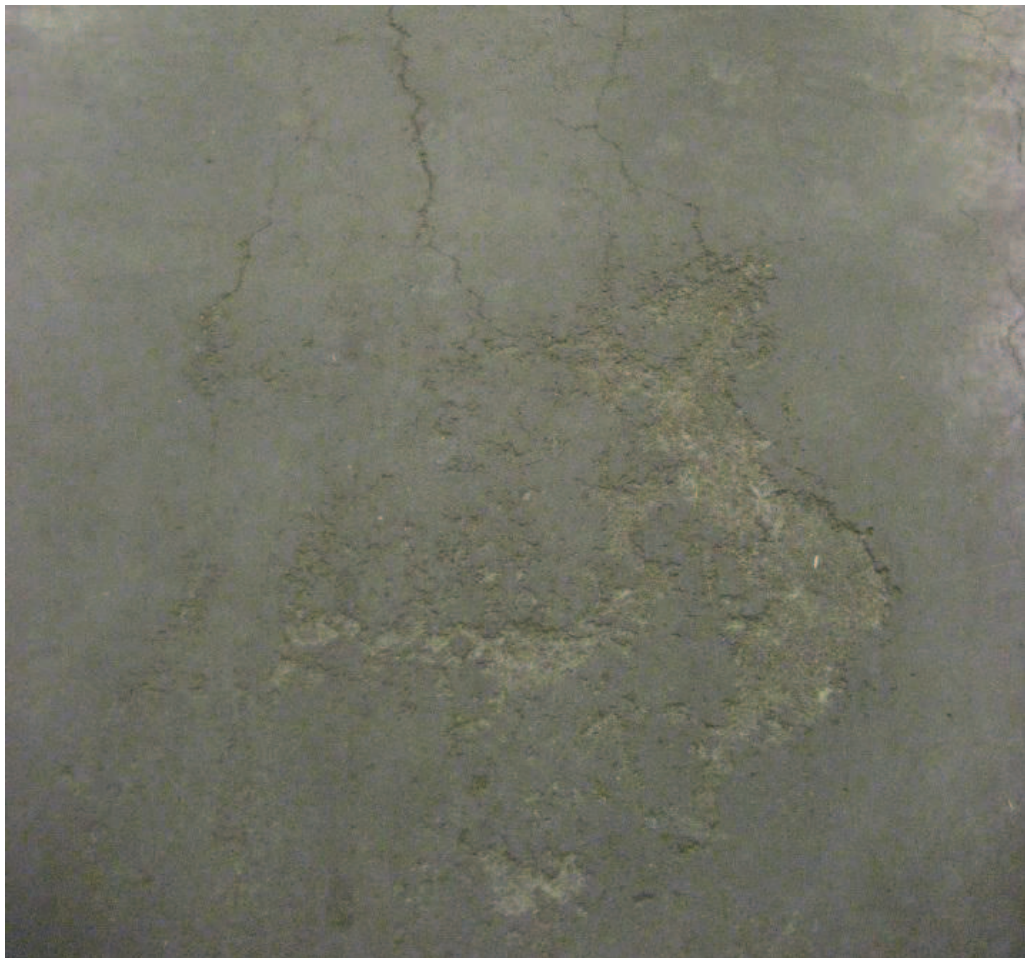
Kuva 8. Sirotteen irtoamista betonin pinnasta. (Kuva: Vahanen Oy.)
