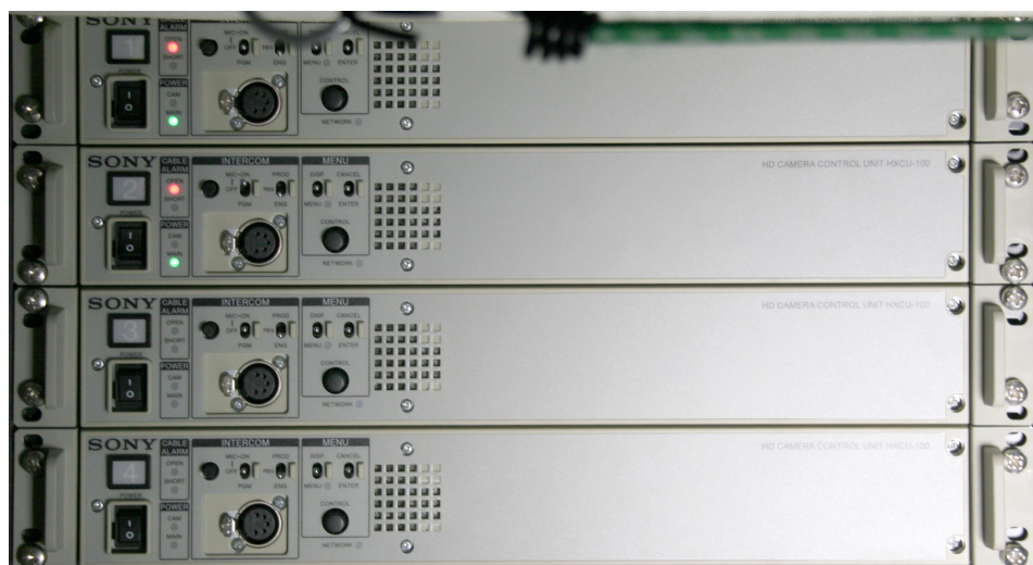
Kuva 105. CCU-laitteita takapöydän alla
