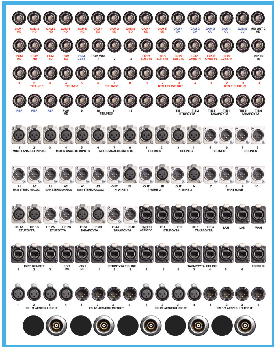
Kuva 31. Back Patch Panel
