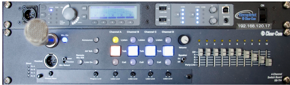
Kuva 110. Claer-Com puhelinpääkeskus (alhaalla) ja Tempest Clear-Com vyöasema-keskus ylhäällä.
