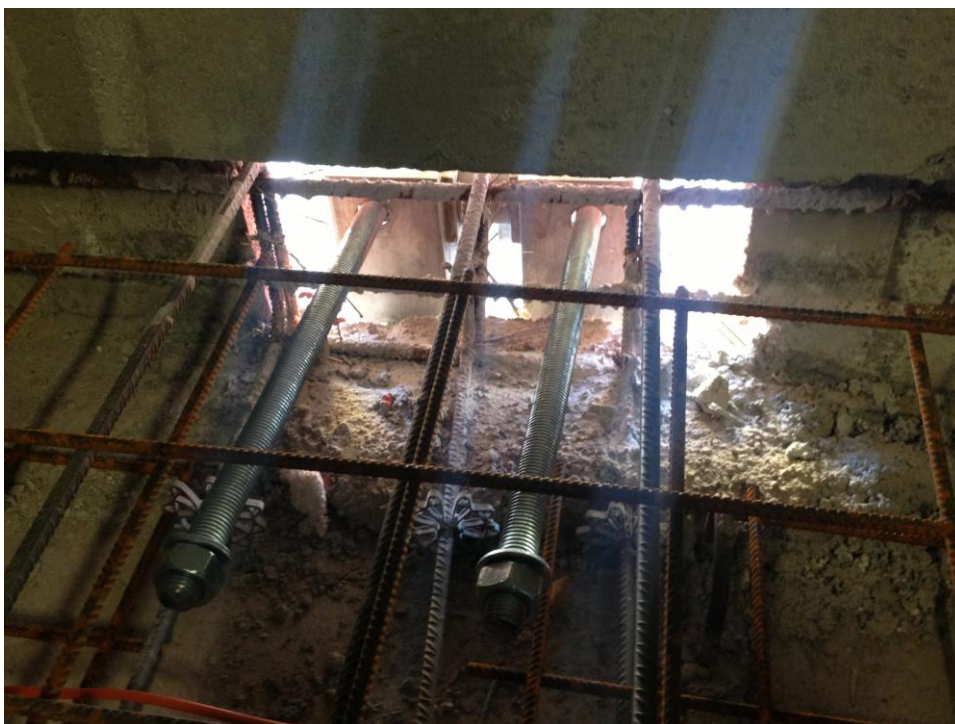
Kuva 20. Kuorilaatasta johtuva ongelma Helsingin Teräksessä.
