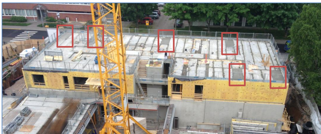
Kuva 7. Parvekekiinnikkeille valetut lisäraudoitteet välipohjassa.
