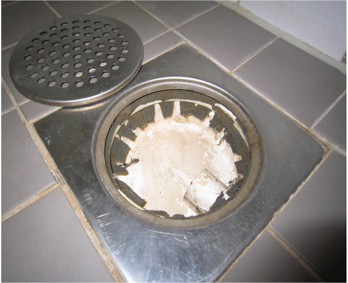
Kuva 5. Kuva todellisesta vauriokohteesta. Kohde on alle 10 vuotta sitten valmistunut kylpyhuone, jossa on käytetty siveltävää vedeneristettä. Lattiakaivon liitoksen teko ei ole onnistunut. Syynä on ilmeisesti se, että tekijällä ei ole ollut ammattitaitoa. Kaivon vahvikekappale on leikattu säteittäin ja leikkaukset ulottuvat kaivon ja kiristysrenkaan väliin. Liitoksen puutteet paljastuivat alakerran asunnon kylpyhuoneen katossa olevana kosteusvauriona.
