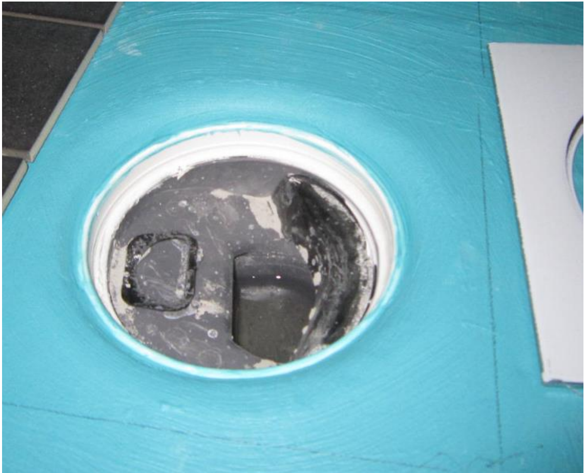
Kuva 4. Kuvassa näkyy oikein tehty lattiakaivon liitos. Kaivon kiristysrenkas ja vahvikekappale ovat oikein asennettuna. Työn jälki on siistiä ja ammattimaista. Liitos on tiivis. Kuva kylpyhuoneremontista, saneeraustyömaalta.
