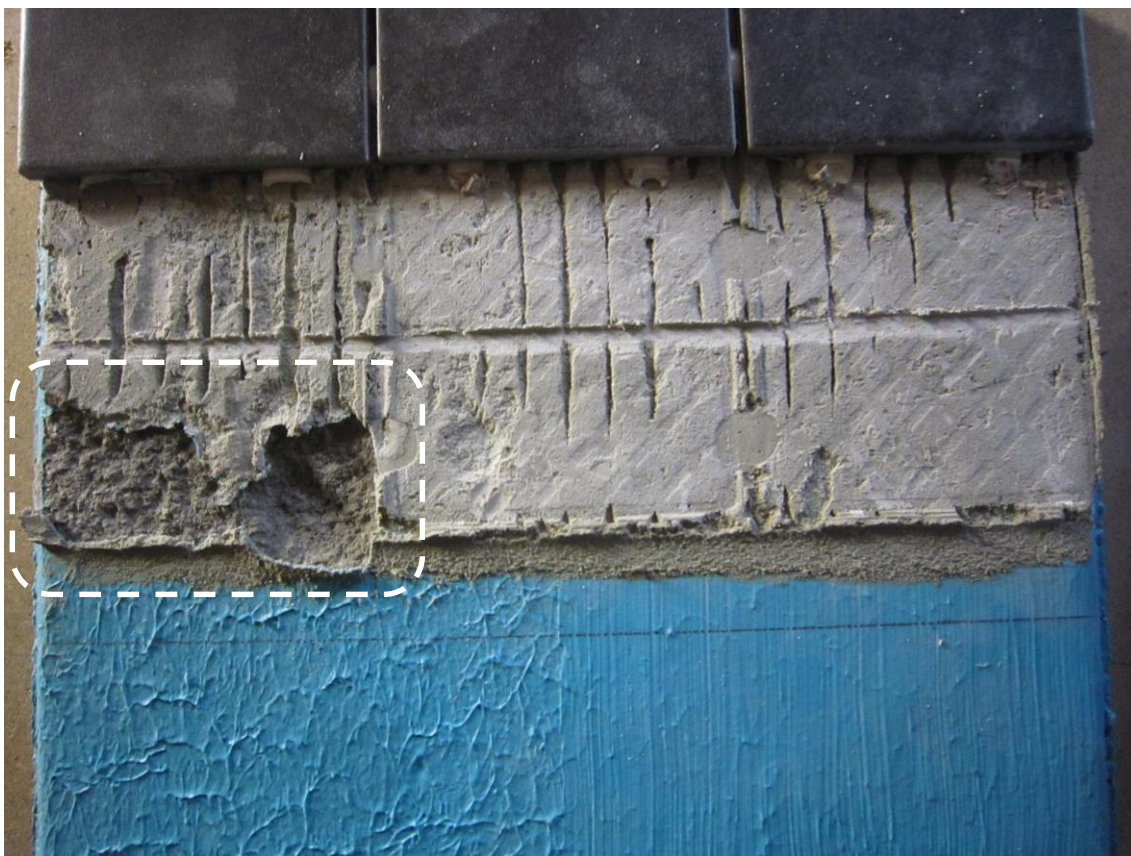
Kuva 15. Laatan irrottaminen kokonaisena johtaa helposti myös alustan pettämiseen. Laatoituksen mukana irronnut alue on rajattu katkoviivalla.
