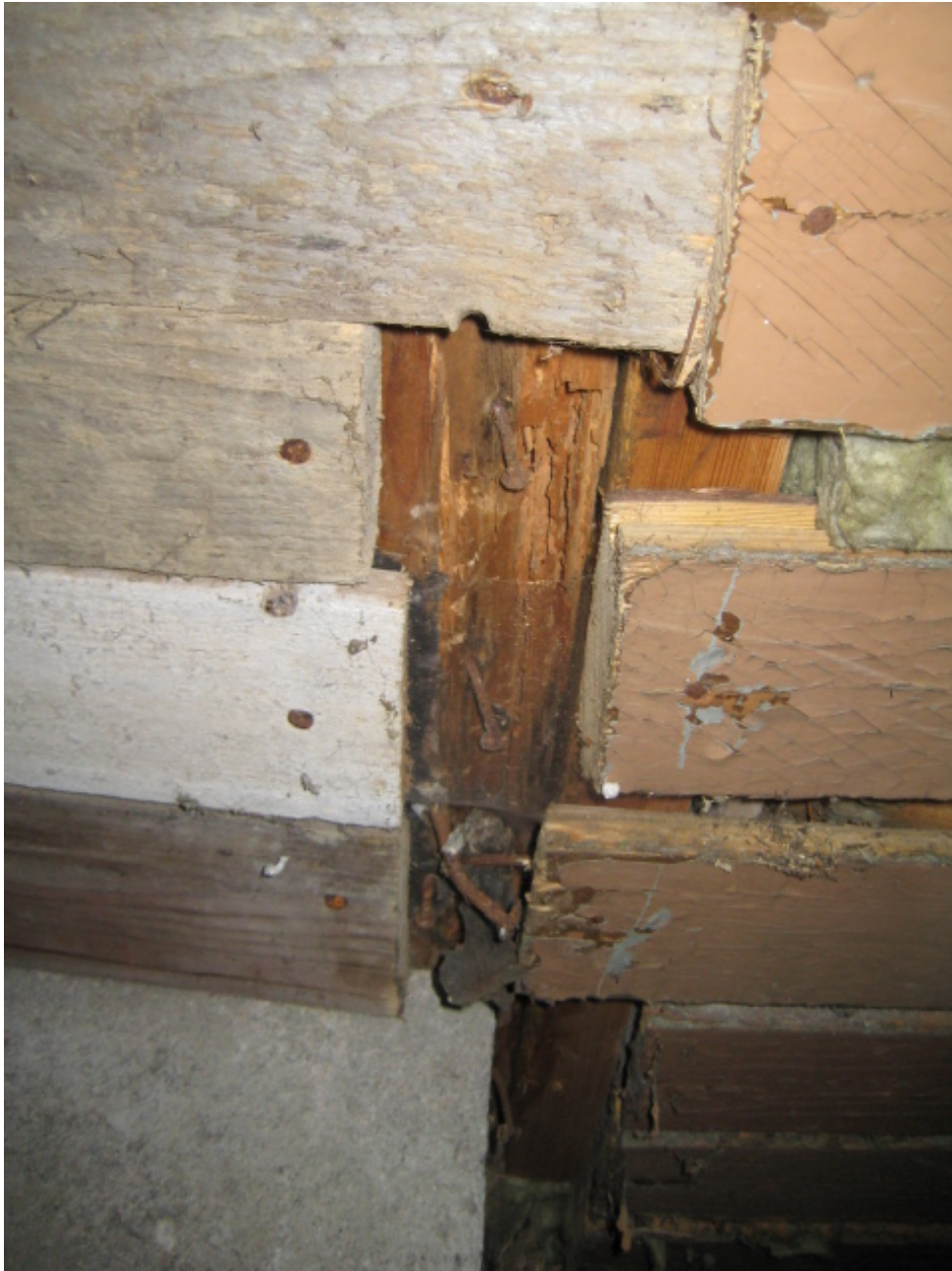
KUVA 5. Huonokuntoinen rossipohjan puupalkki.
