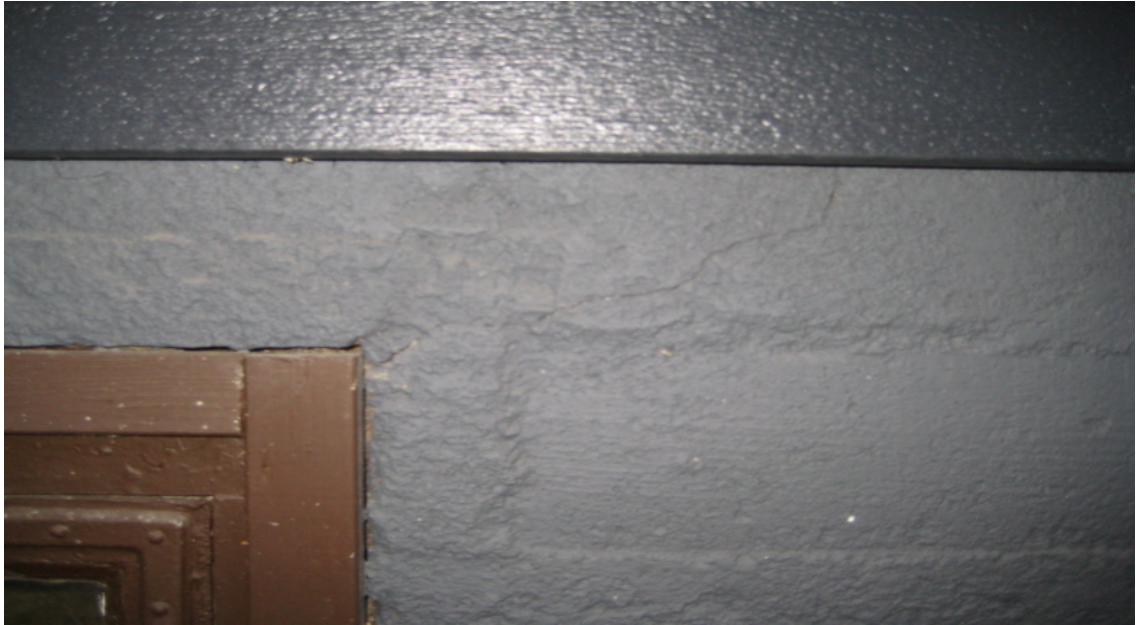
KUVA 3. Halkeama rossipohjan tuuletusaukon nurkassa.
