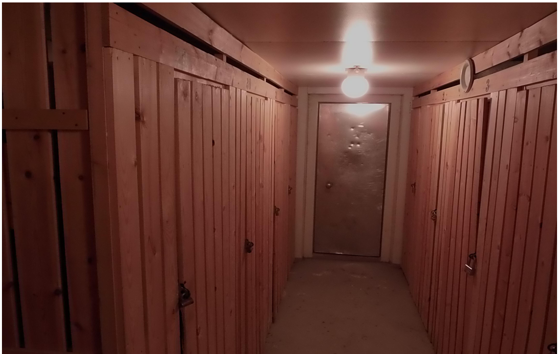
Kuva 2. Kylmäkomoja on 32 kpl ja tilassa on 2 kpl luonnollisen ilmankierron höyrystintä. Poistoilmaventtiili näkyy kuvassa käytävän keskivaiheilla.
