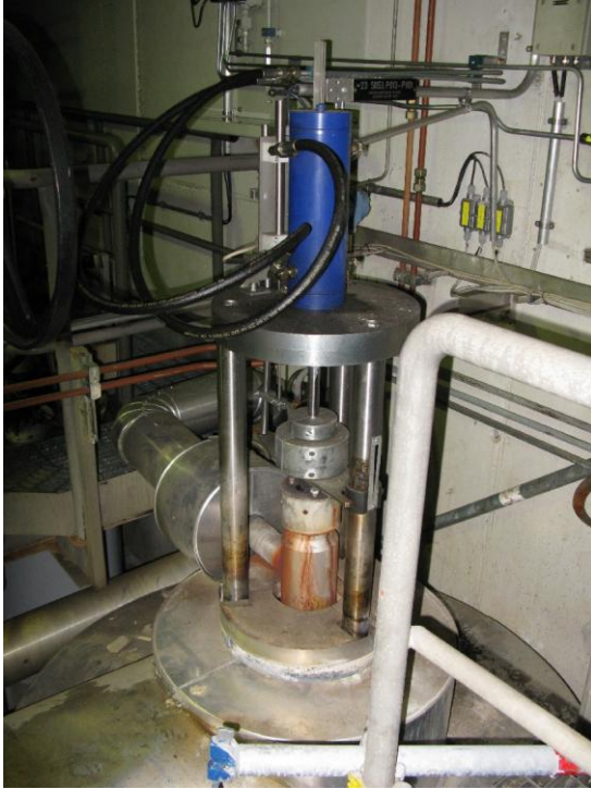
Kuva 7.1 Höyryverkoston paineenalennus- eli reduktioventtiili
