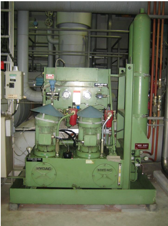
Kuva 7.2 Soodakattilan reduktioventtiileiden nykyinen hydraulikoneikko
