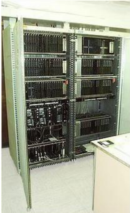
Kuva 1. Piirikytkentäinen puhelinvaihde (Overstreet 2011).
