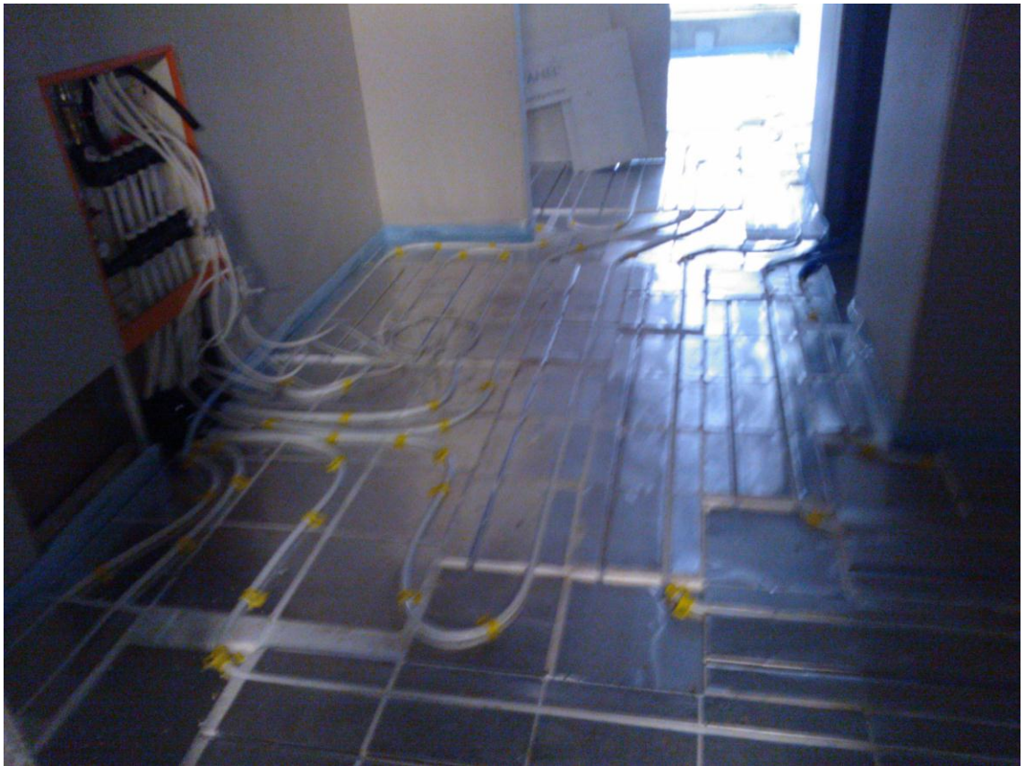
Kuva 13. Weber-lattialämmityslevyt ja Uponor-putkistot
