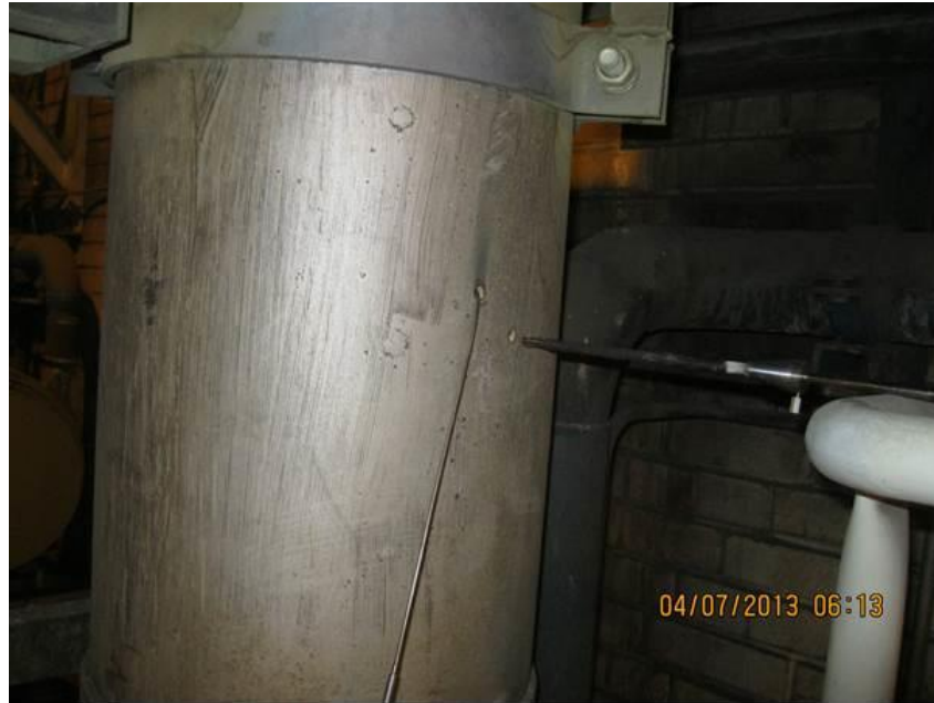
Kuva 21. Savukaasuputki, jossa ovat vierekkäin anturit savukaasulle ja lämpötilalle
