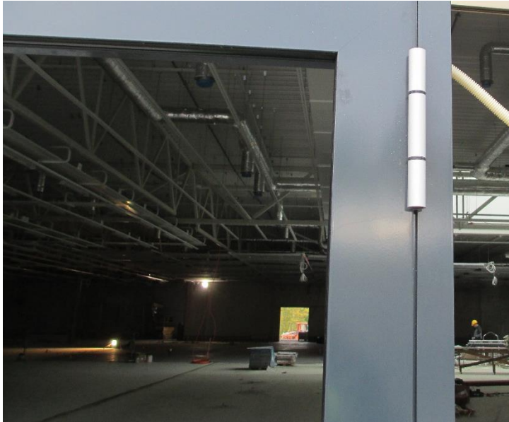
Kuva 9. Pääsisäänkäynnin liukuoven viereinen avautuva pieli paniikkisaranoilla
