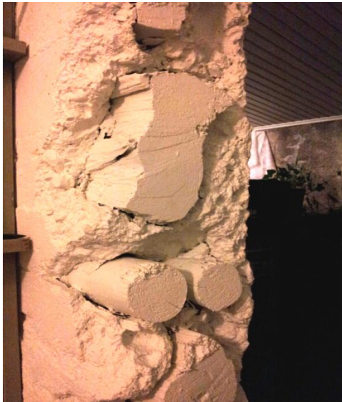
KUVA 8. Vanhassa kantavassa väliseinässä on käytetty ”säästöbetonia”
