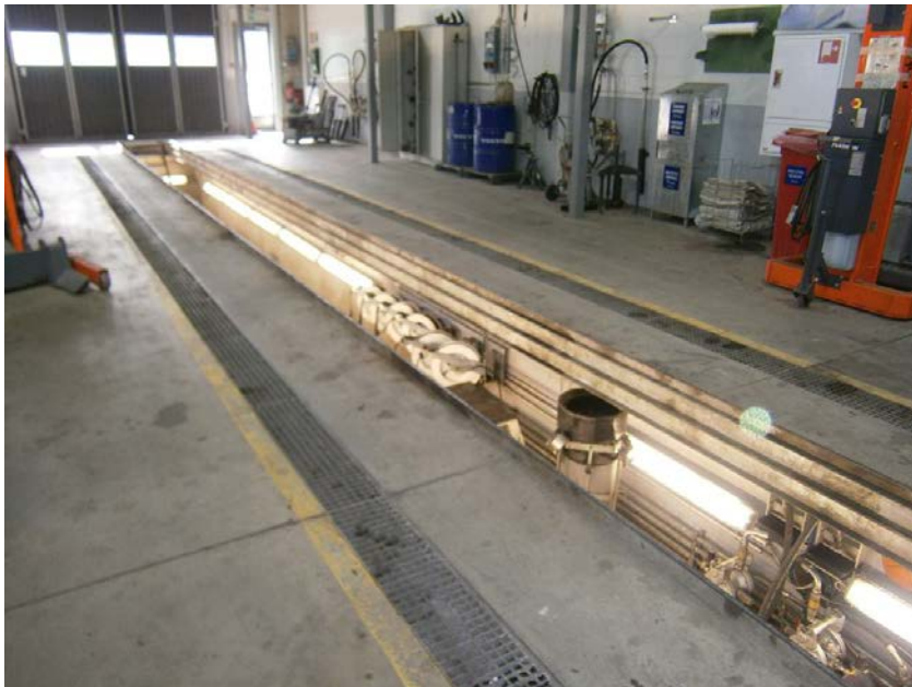
Kuva 9. Huoltokuilu ilman huomioväriä
