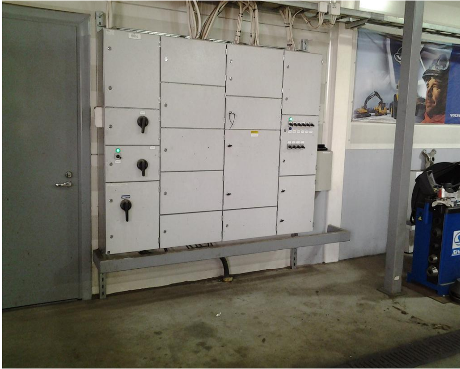
Kuva 13. Sähkökaapin edusta puhtaana
