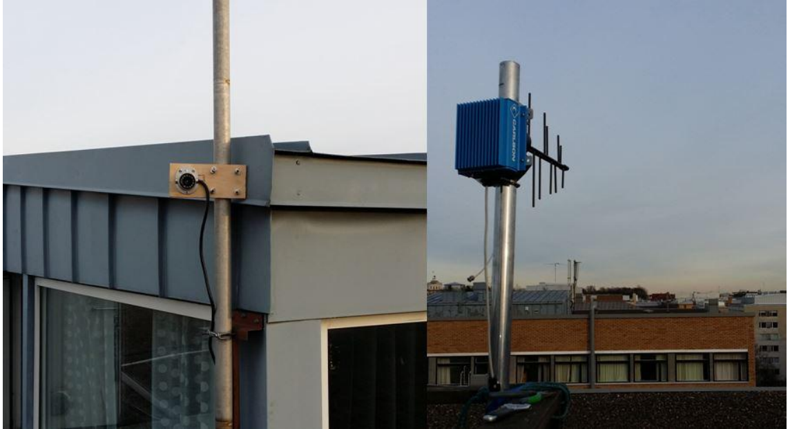
Kuva 32 Sepänekadun radiolaitteisto sekä valvontakamera asennettuina. Radiolaitteisto ja valvontakamera sijoitettiin katolla erilleen.
