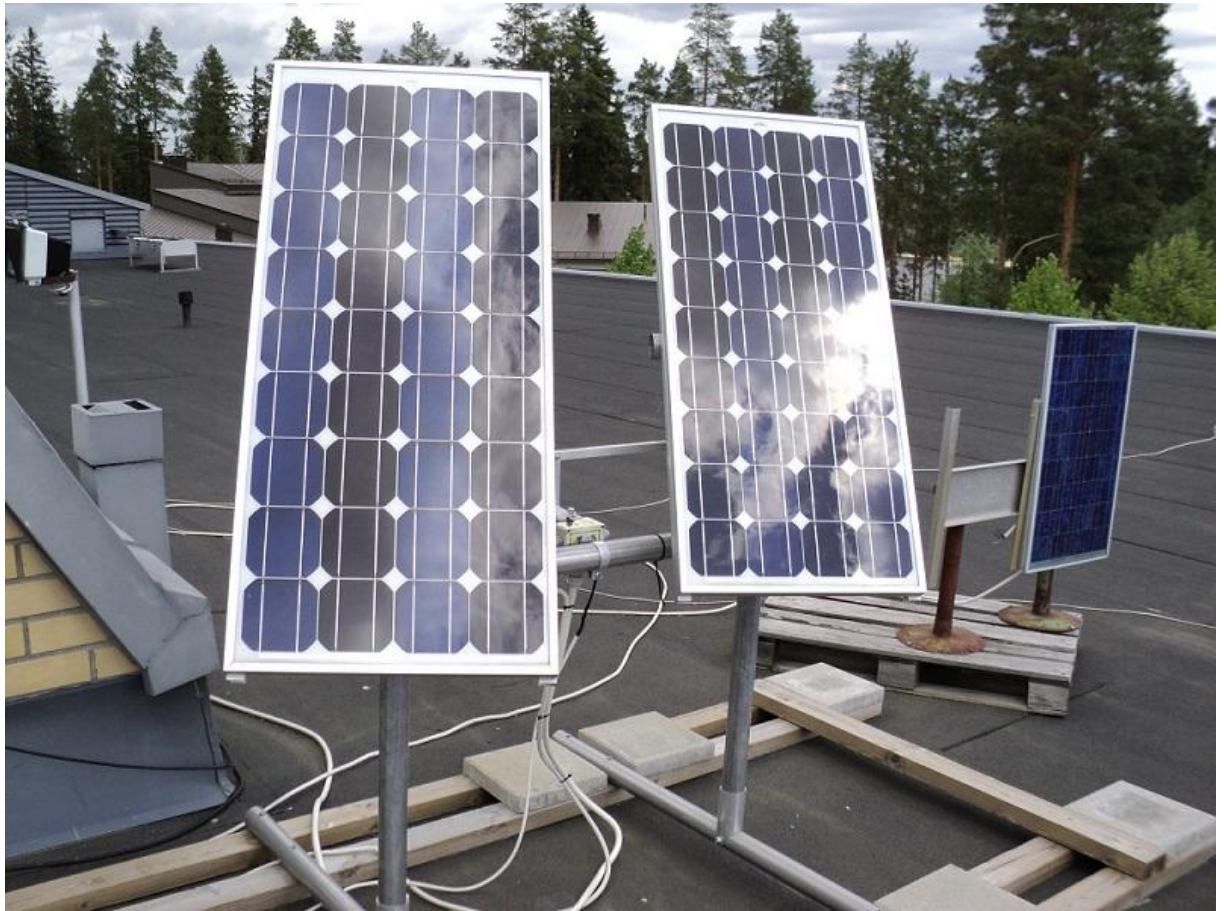
KUVA 1. Kahden paneelin ryhmä tukirakenteineen.
