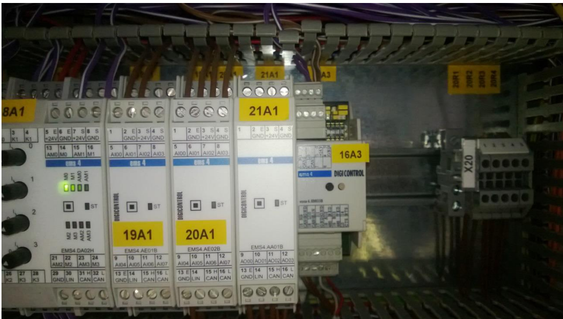
KUVA 9. Moduuli 16A3 GEA CAIRfricostar -keskuksessa
