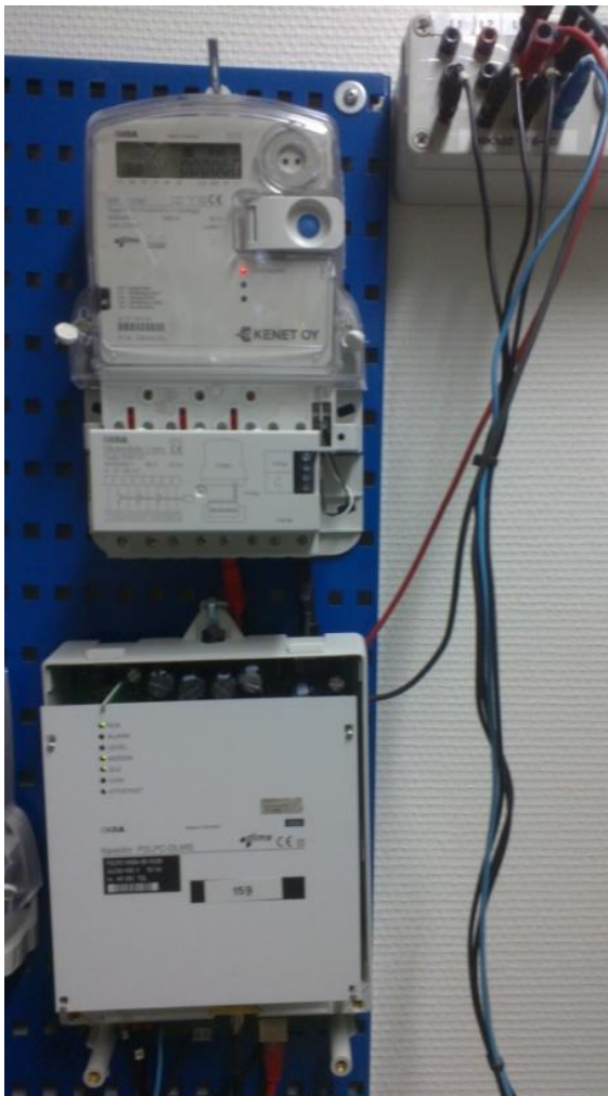
Kuva 10. Testausaseman rakenne ensimmäisten mittausten aikana.
