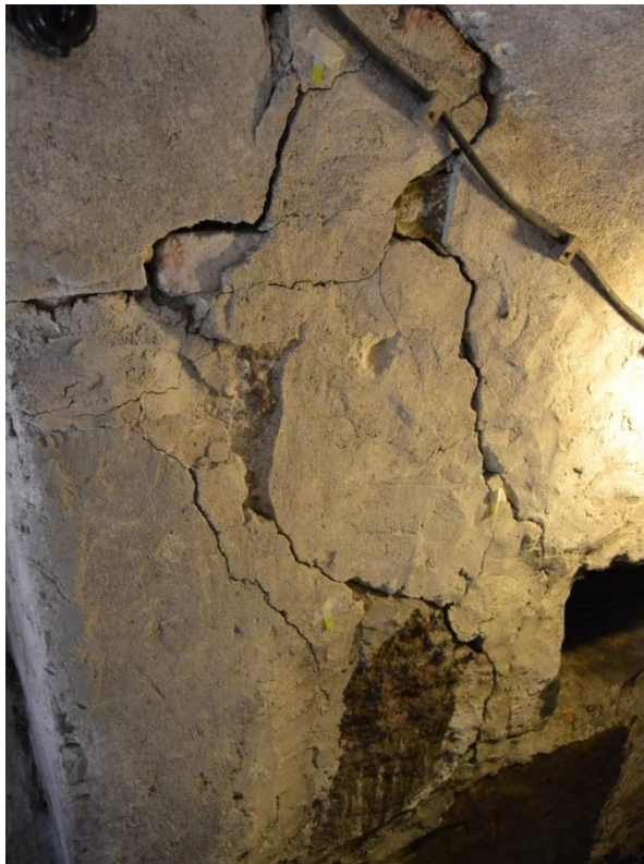
Kuva 2 Kellarin halssin rappauksen vaurioita.
