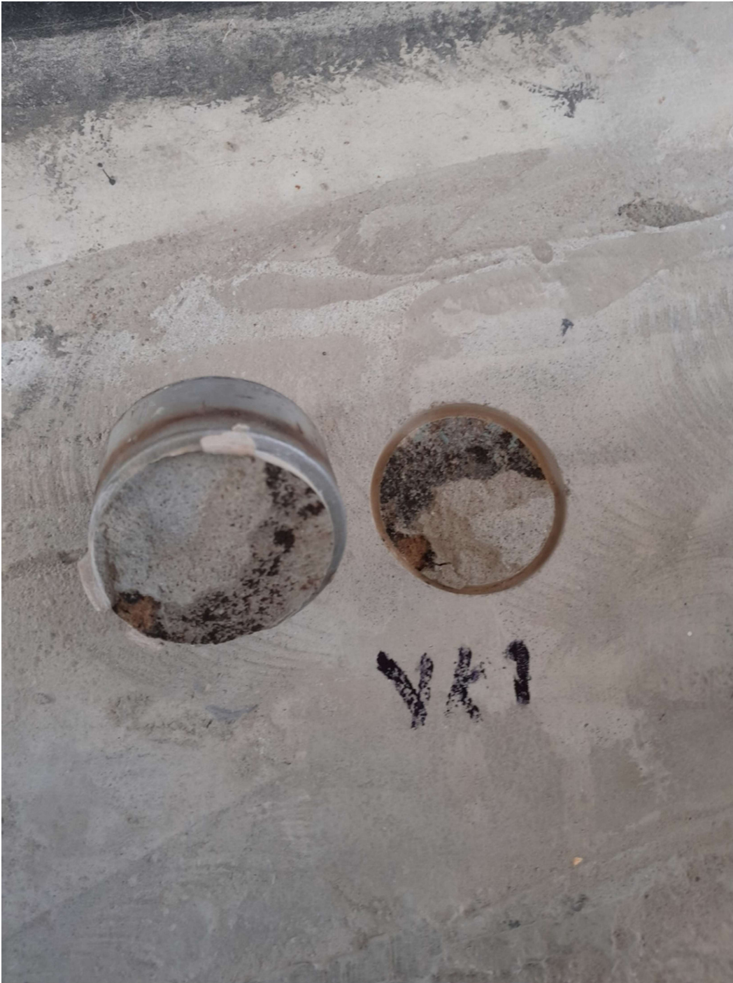
Kuva 5. Betonipinnan vetokokeen murtopinnat.
