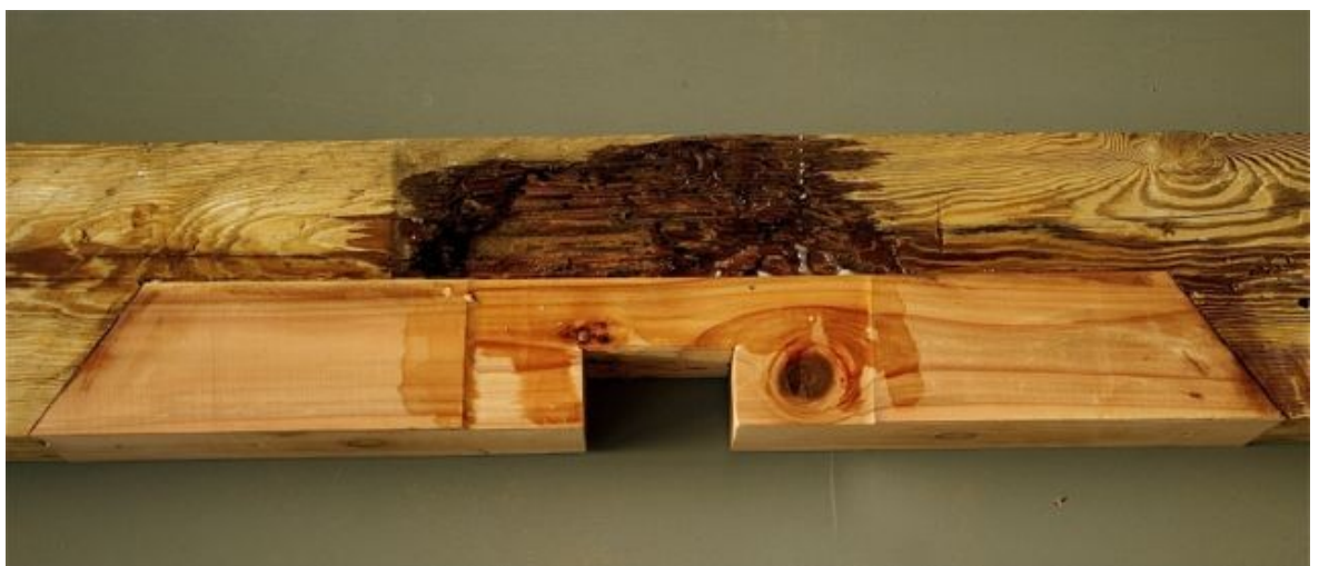
Kuvio 36: Palkin vaurio on korjattu materiaalin vaihdolla sekä lujittamalla puuta kemiallisesti.
