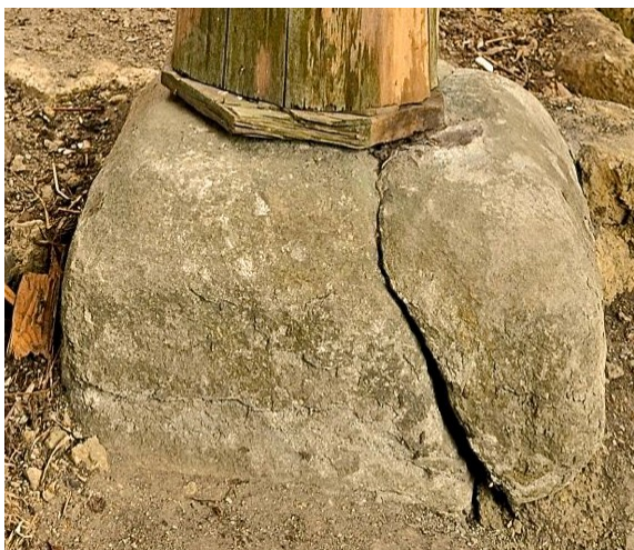
Kuvio 26: Vian ja maanjäristysten vuoksi haljennut perustuskivi esiinkaivettuna.
