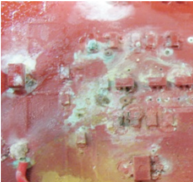
Kuvio 15. Vaurioitunut suojaus (Corrosion of Electronics 2013, 6)
