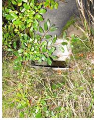
Siirtynyt rumpu, ulkopäästä
