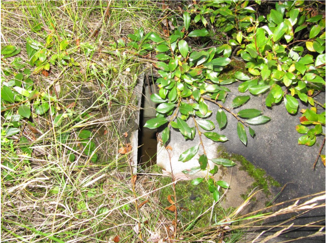
KUVA 5. Siirtynyt betonirumpu ulkopuolelta.
