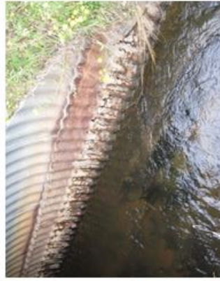
Teräsrumpu on ruostunut
