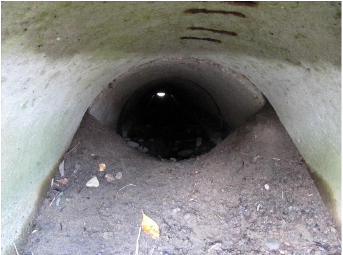
KUVA 4. Siirtynyt betonirumpu sisäpuolelta.
