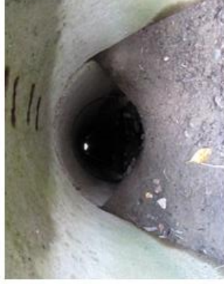
Siirtynyt rumpu, sisältäpäin
