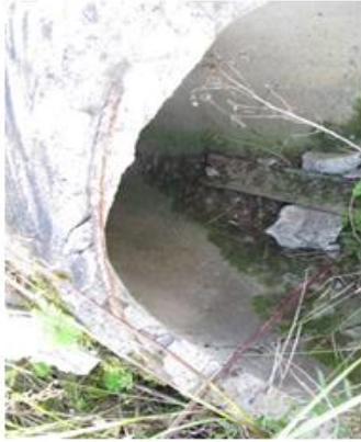
Teräsbetonirumppu on rikki
