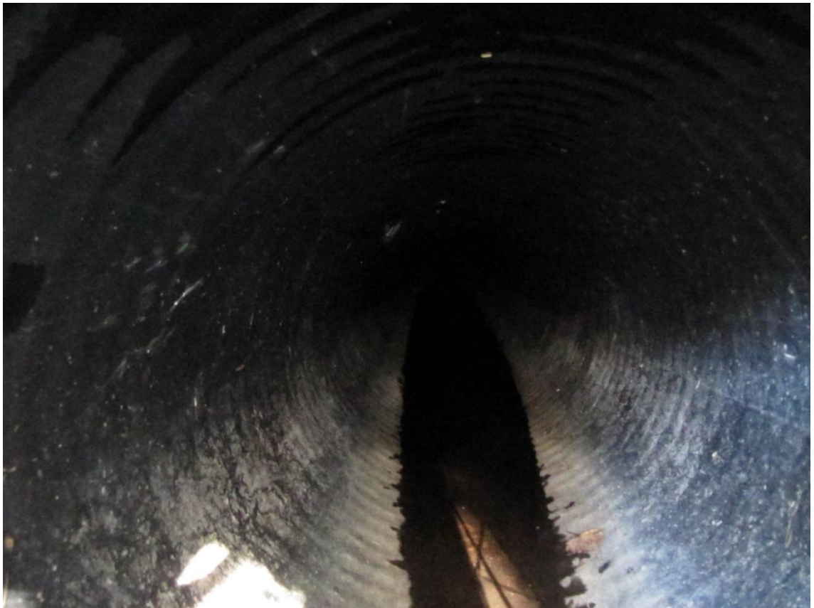
KUVA 12. Muovirumpu, josta ei näy läpi.
