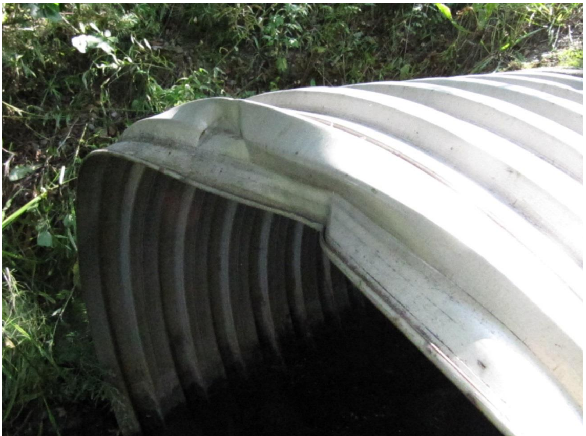
KUVA 8. Teräsrumpu, joka on lytyssä eli rikki.
