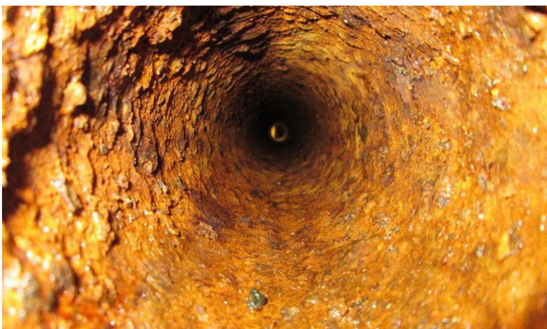
Kuva 11. Korroosio valurautaputken sisällä.
