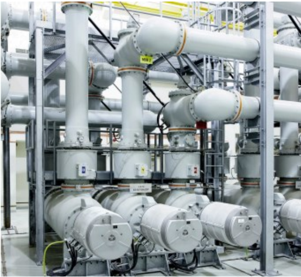
KUVA 3. Kaasueristeisen sähköaseman (GIS) rakenteita (10)
