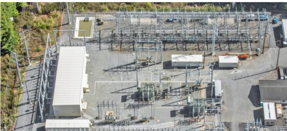
KUVA 4. Ilmaeristeisen sähköaseman (AIS) rakenteita (10)
