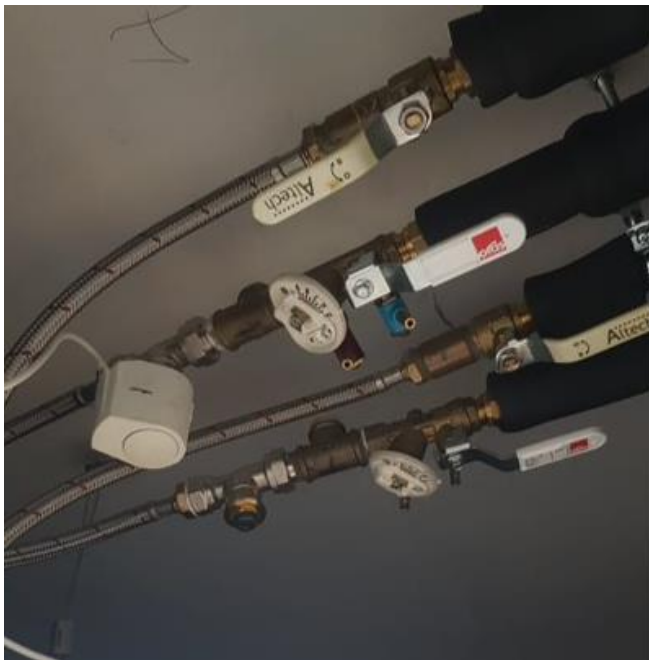
Kuva 12. Kytcentä ennen säteilypaneelia. Kuvassa poistettu lämmityspuolen toimilaite (1).
