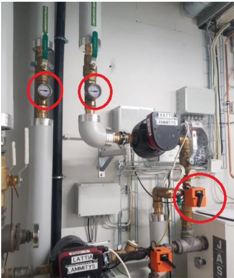
Kuva 13. Lämmitysjärjestelmien pumput ja sekoitusventtiilit. Kuvassa ympyröitynä lämpötilat ja Belimo-toimilaite väärässä asennossa (1).
