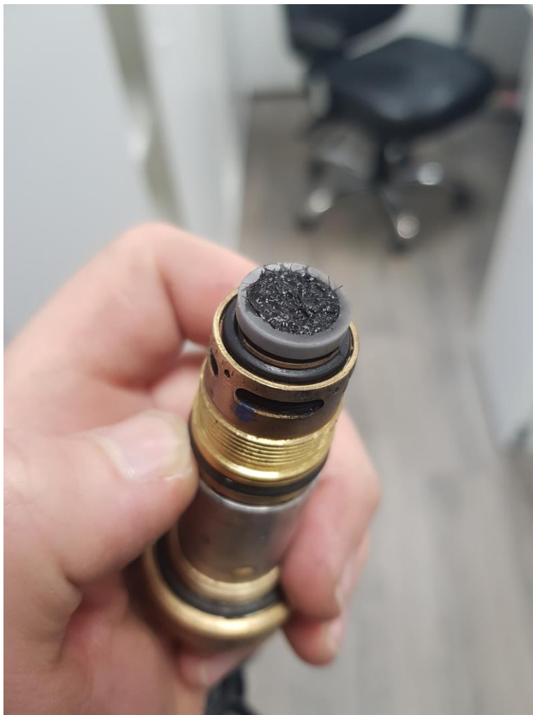
Kuva 19. Patteriventtiin sihti tukossa (1).
