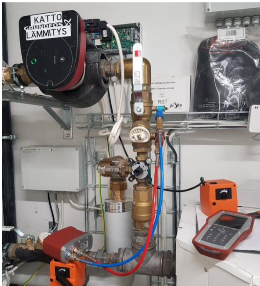
Kuva 14. Linjasäätöventtiin tilavuusvirran mittaaminen (1).
