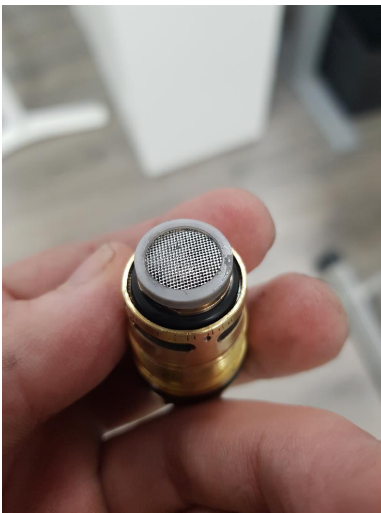
Kuva 20. Patteriventtiilin sihti puhdistettuna (1).
