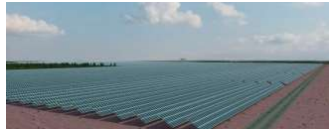
Aurinkopaneelit kiinteällä maa-asennuksella (2)
