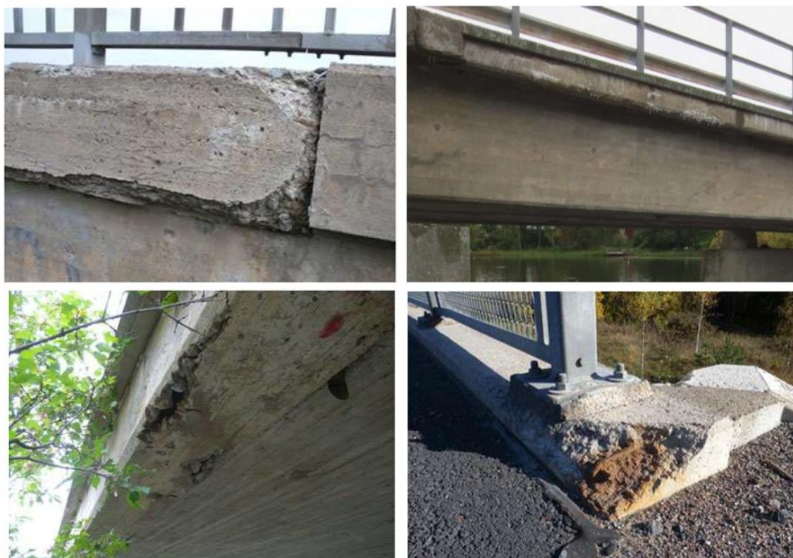
KUVA 9. Ylhäällä vasemmalla kuvassa on reunapalkin pakkasrapautumisesta johtuva pintavaurio, ylhäällä oikealla vesivaurio, alhaalla vasemmalla valuvika ja alhaalla oikealla lohkeamavaurio (Sillan tarkastuskäsikirja 2020)
