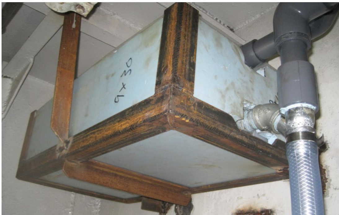
Kuva 15. Varastosäiliö asennettuna kehtoonsa. Ylempi Pvc linja on tulo ja galvanoitu alempi on yhde pumpulle. Etualalla oleva muovi/pvc linja on jäähdytysveden syöttölinja.
