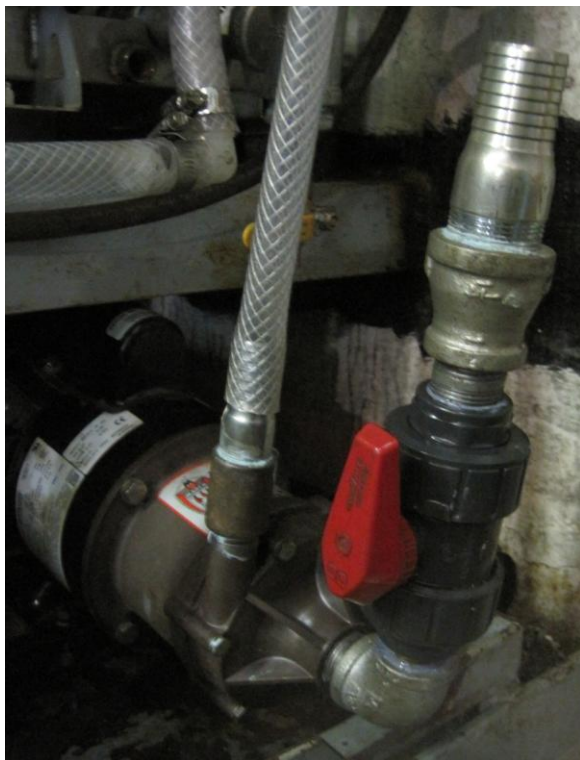
Kuva 16. Jäähdytysvesipumppu. Imupuolen palloventiili etualalla
