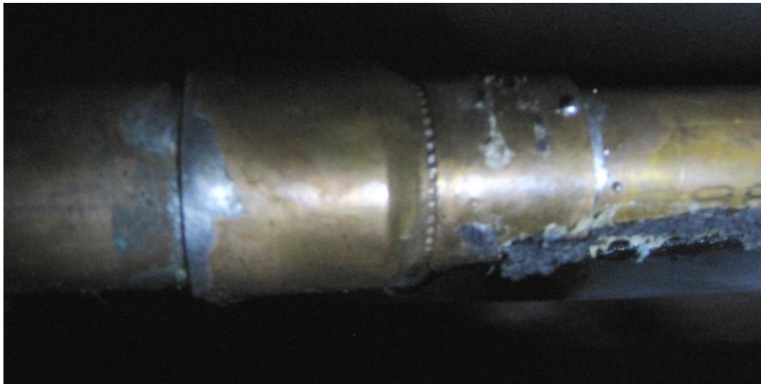
Kuva 12. Ehjältä näyttävä, vuotava liitos
