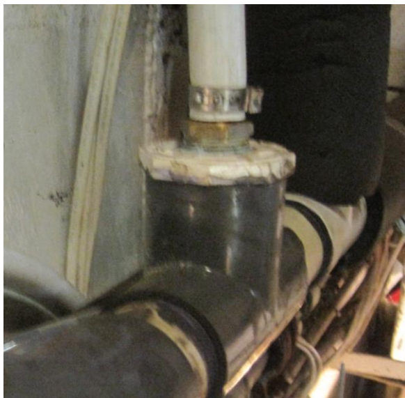
Kuva 14. Paisuntasäiliön haara päälinjan paluupuolella
