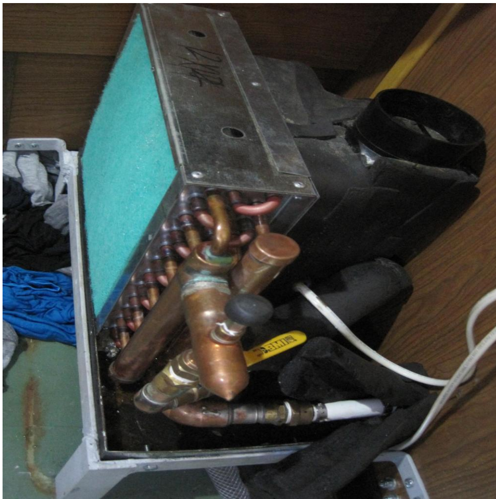
Kuva9. Kansitason hytin tuuletinyksikkö. Kuvasta näkyy hyvin imufiltteri sekä jäähdytysilman ulostulokanava
