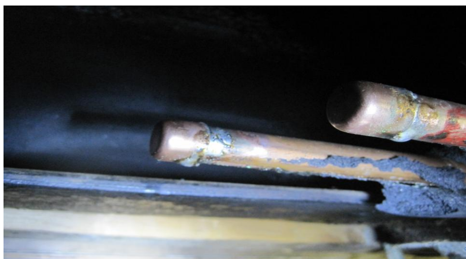
Kuva 11. Kupariputkien vanhoja haaroja jouduttiin tulppaamaan
