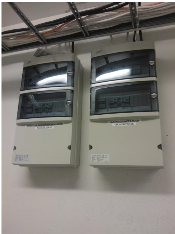
KUVA 14. Pumppaamoiden ohjauskeskukset (Vierikko 2013-09-16)
