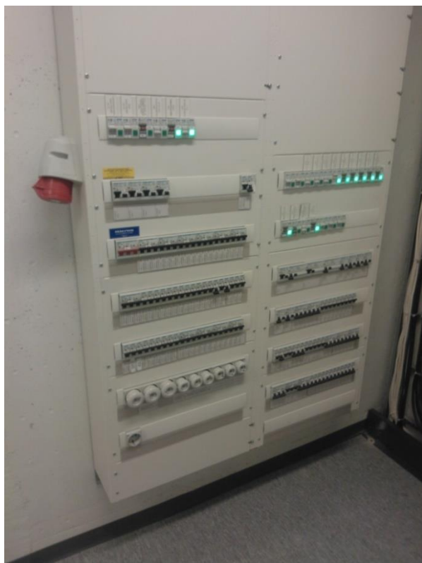
KUVA 13. Kiinteistön sulakkeet (Vierikko 2013-09-16)
