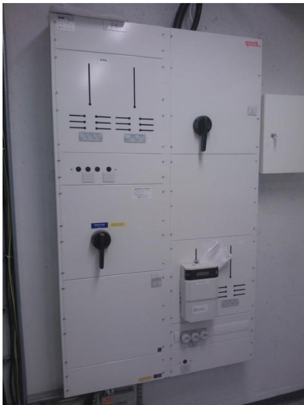
KUVA 12. Kiinteistön pääkeskus ja pääkytkin (Vierikko 2013-09-16)
