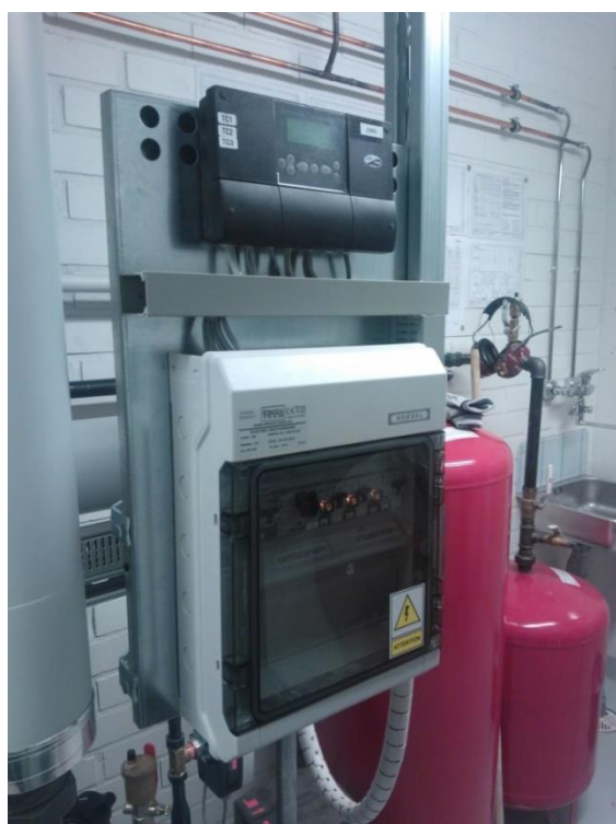
KUVA 16. Lämmitysjärjestelmän ohjaus (Vierikko 2013-09-16)
