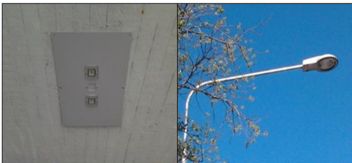
KUVA 4. Alikulkitunnelissa oleva LED-valaisin ja autotien 150W suurpainenatriumvalaisin Matkuksesta (Kokkonen 2013.)
