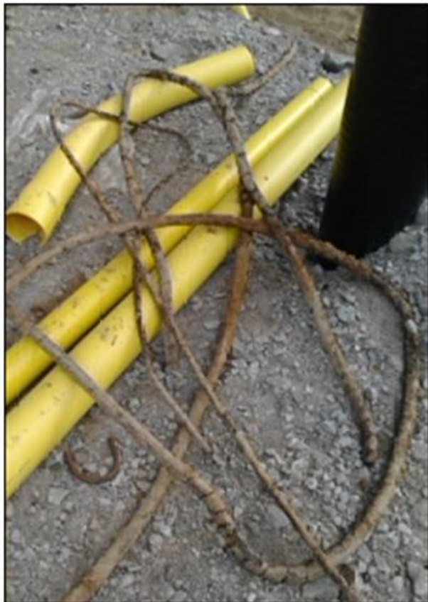
KUVA.2 Kuvassa keskellä vanhaa PLKVJ kaapelia Niiralankadun ulkovalosaneeraus työmaalta. Kaapelia suojaava lyijyvaippa on hapettunut ruskean väriseksi. (Kokkonen 2013.)
