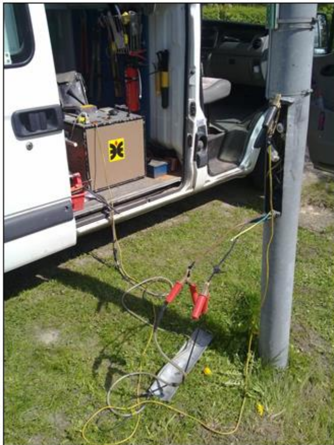
KUVA.5 UV-maakaapelivian etsintää impulssigeneraattorin ja kuuntelulaitteen avulla Puutarhakadulla. (Kokkonen 2012.)
