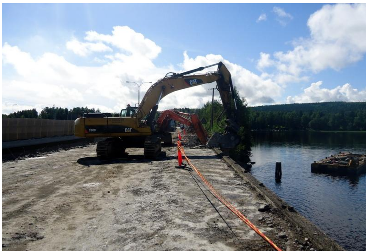
KUVA 1. Sillan ulokkeiden purkutyöt ovat käynnissä. Sillanreuna oli suojattu varoitussauhalla koneiden ajaksi. (Willman 2013-08-12.)
