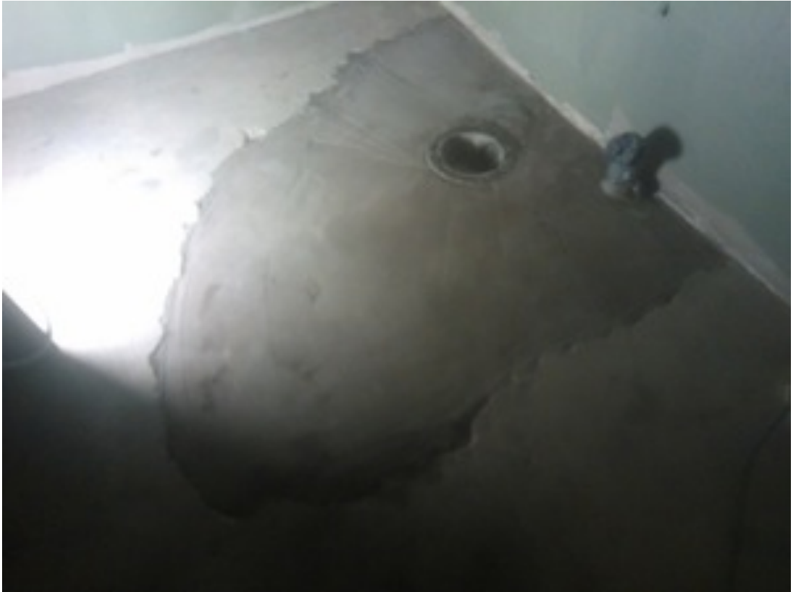
Kuva 2. Kastunut osa lattiasta piikkattu auki ja täytetty uudestaan.
