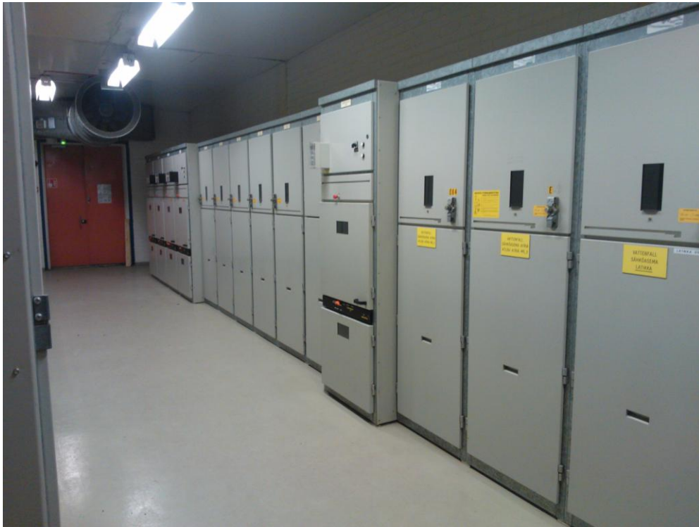
Kuva 2. Käytössä oleva muuntamotila ja keskijännitekojeisto.
