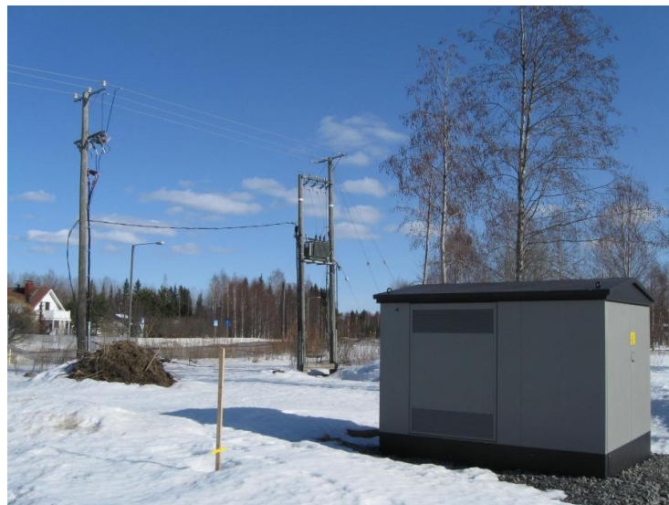
Kuva 5. Puistomuuntamo 20 kV/0,4 kV. /8/
