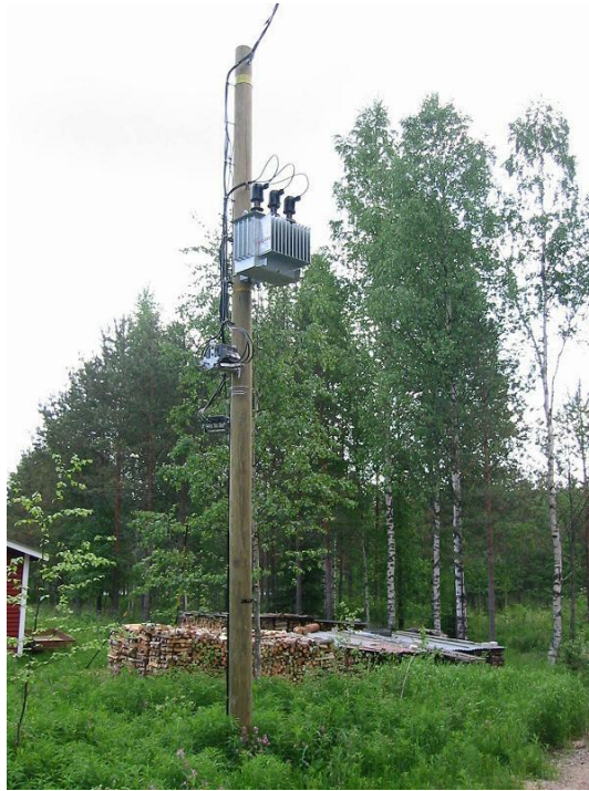
Kuva 4. Pylväsmuuntamo 1 kV/0,4 kV. /9/
