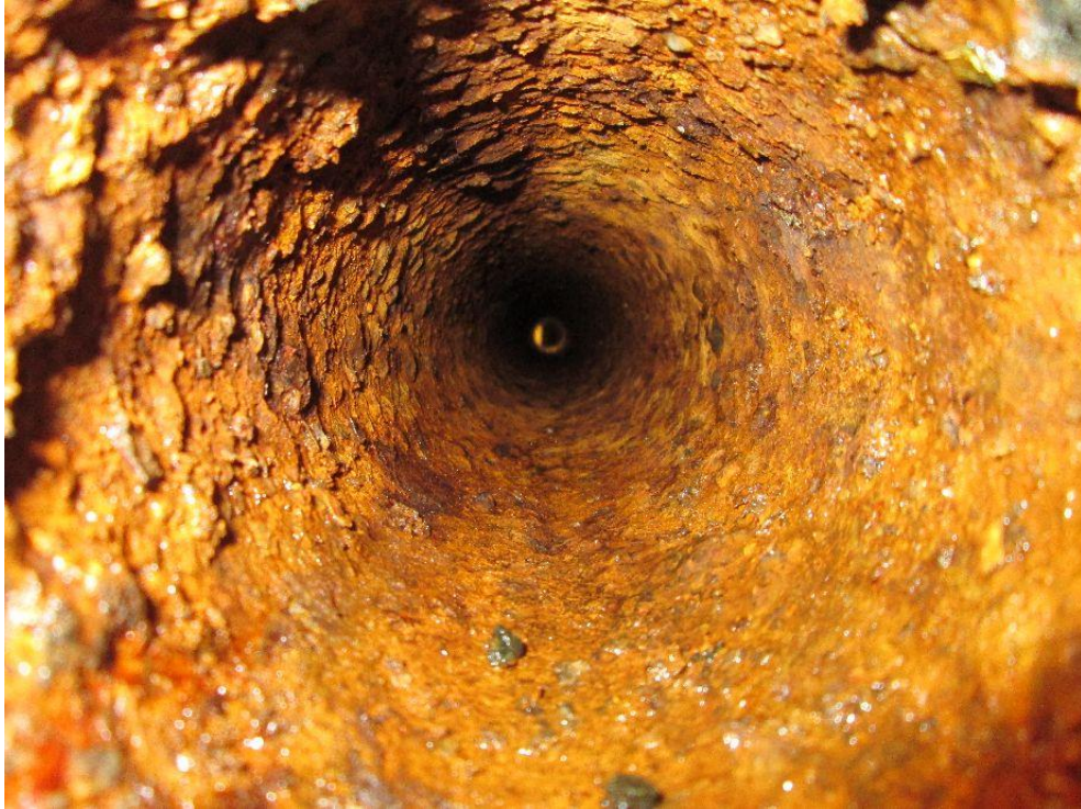
Kuva 5. Pahasti syöpyneen valurautaisen putken sisäpuoli [Granlund Oy]
