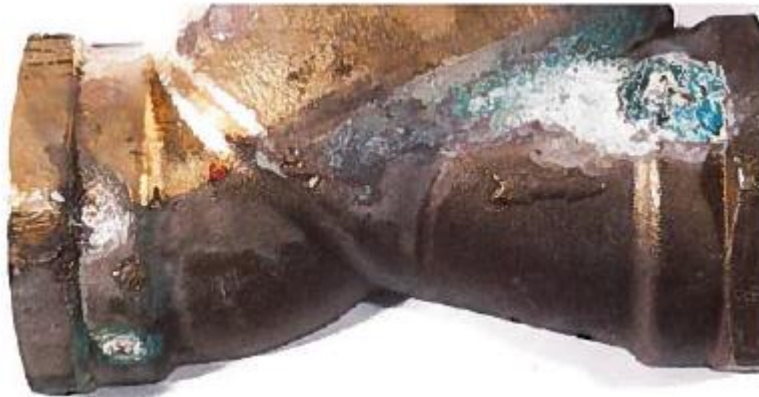
Kuva 9. Sinkinkadon vaurioittama messinkiventtiili [Outokumpu Copper]
