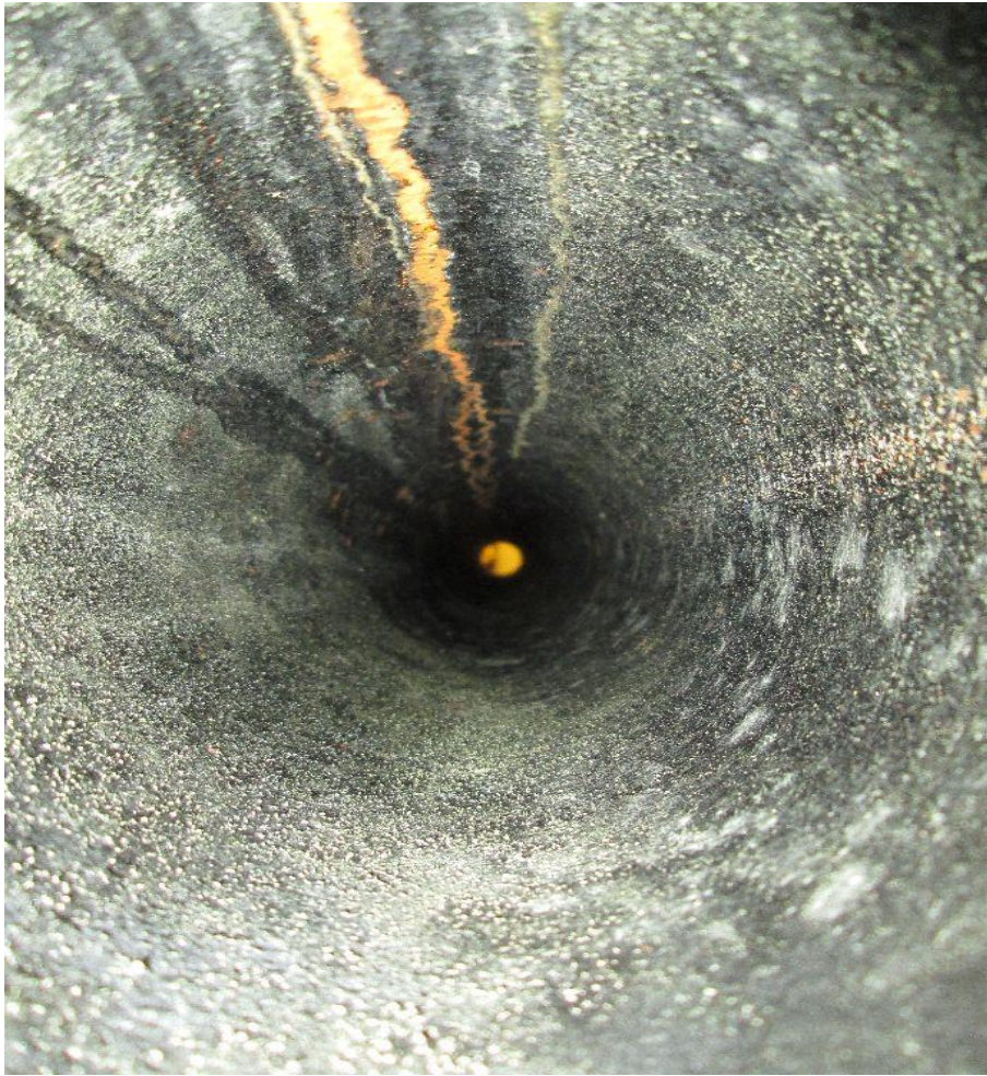
Kuva 6. Valurautaisen putken yläpinnassa keltaista viivamaista mikrobiologista korroosiota [Granlund Oy]
