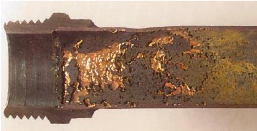
Kuva 8. Kupariputkessa eroosiokorroosiota [Outokumpu Copper]
