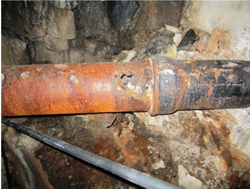
Kuva 4. Puhki asti syöpynyt valurautainen viemäri. Putken ulkopinnalla syöpymää [VTT Expert Services Oy]
