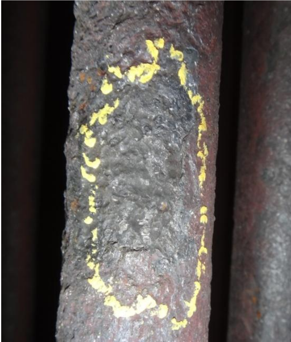
Kuva 5. Kuumakorroosiota tulistinputkessa (materiaali X10CrMoVNb91, sisällön lämpötila 545 °C ja paine 182 bar)
