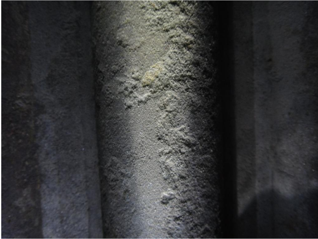
Kuva 17. Tulipesän seinäputken korroosiota
