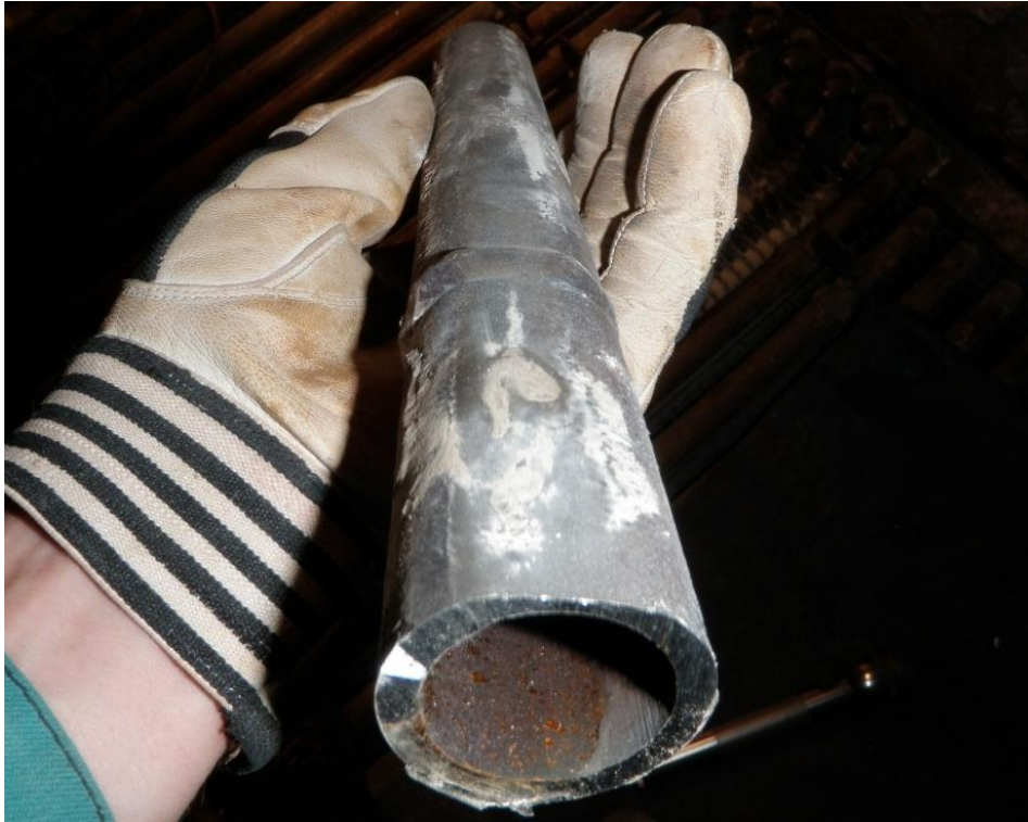
Kuva 7. Erosion kuluttama putki
