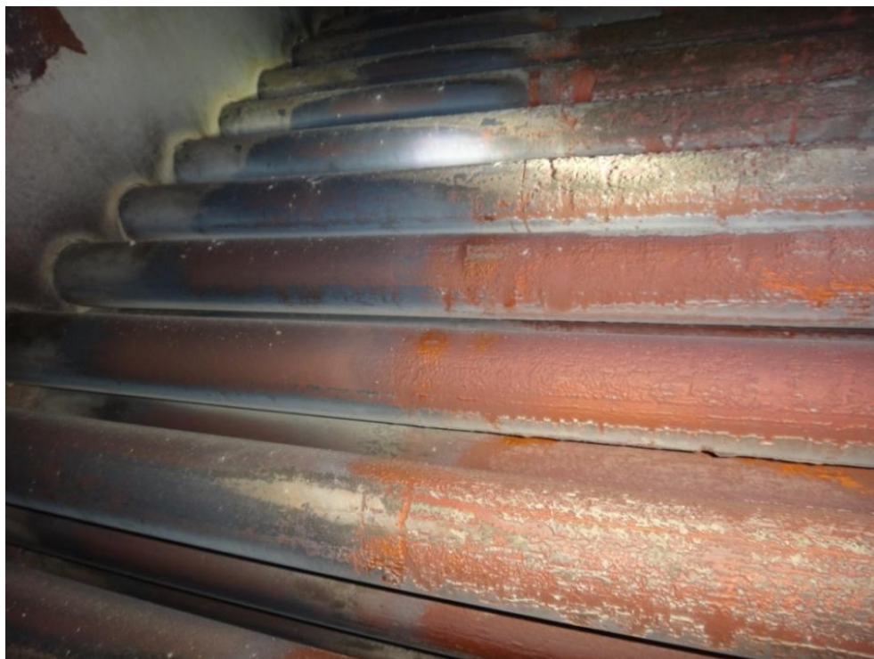
Kuva 26. Kylmän pään korroosiota
