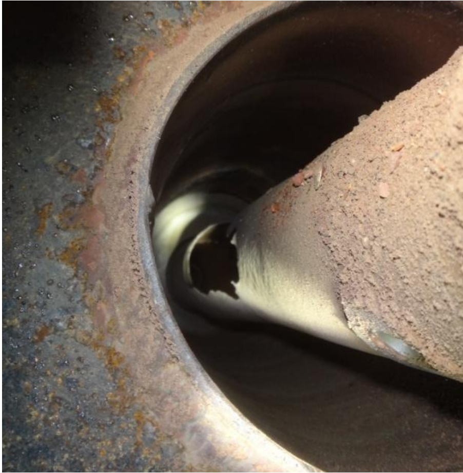
Kuva 29. Nuohoimen lanssiputken läpivientikohdan korroosioaurio
