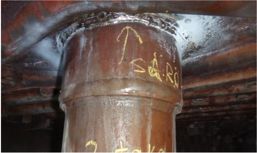
Kuva 16. Tyypillinen leijuarinan vaurio pohjatuhkatorven ja arinan hitsausliitoksessa
