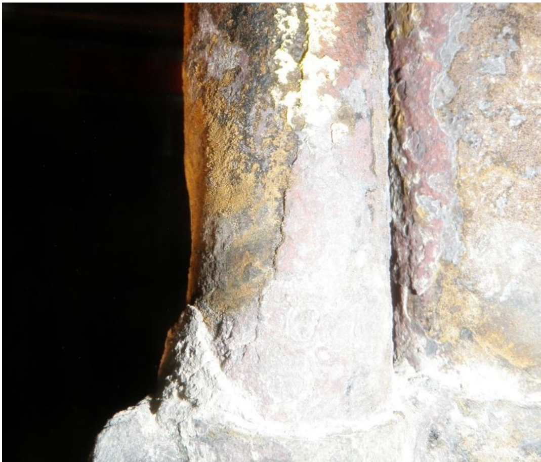
Kuva 8. Korroosio ympäristön rasittama tulistinputki jonka kulumista nuohous on kiihdyttänyt (materiaali: 10CrMo9-10, sisällön lämpötila 450° ja paine 90 bar)
