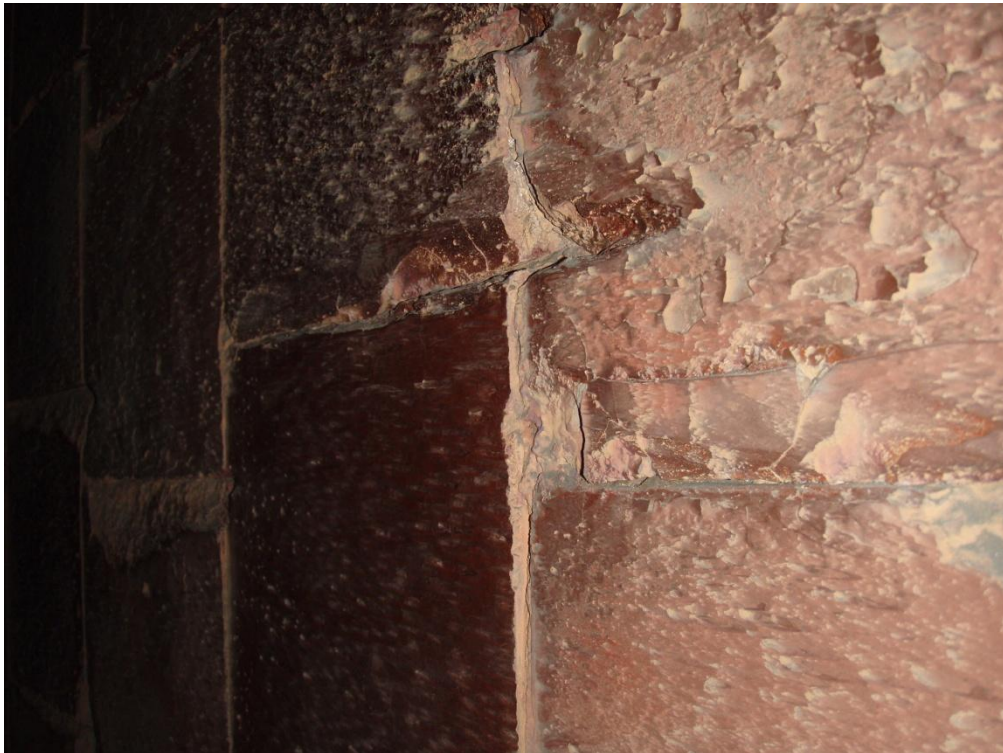
Kuva 27. Syklonin muurausten kulumaa
