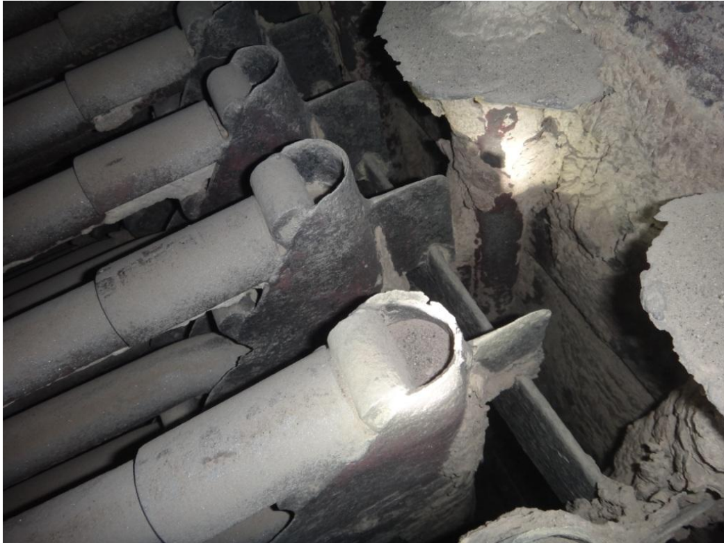
Kuva 22. Höyrystimen ylikuumentuneita sidontoja ja kannatinrakenteita
