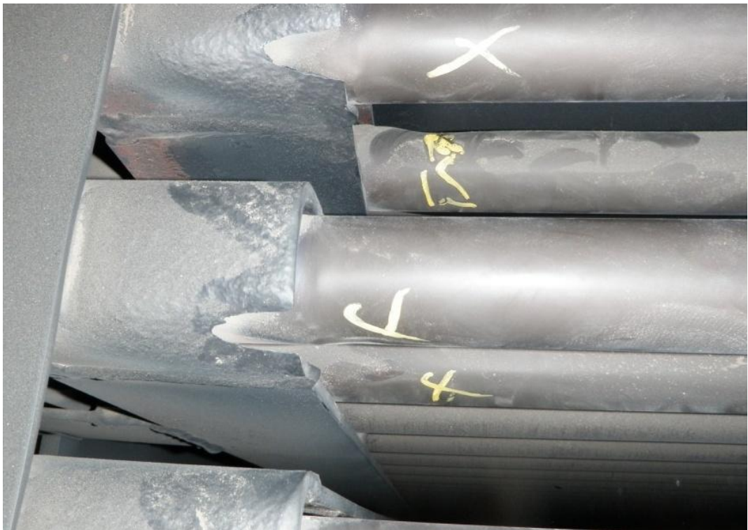
Kuva 6. Eroosion aiheuttamaa kulumaa ekonomaiserin elementeissä
