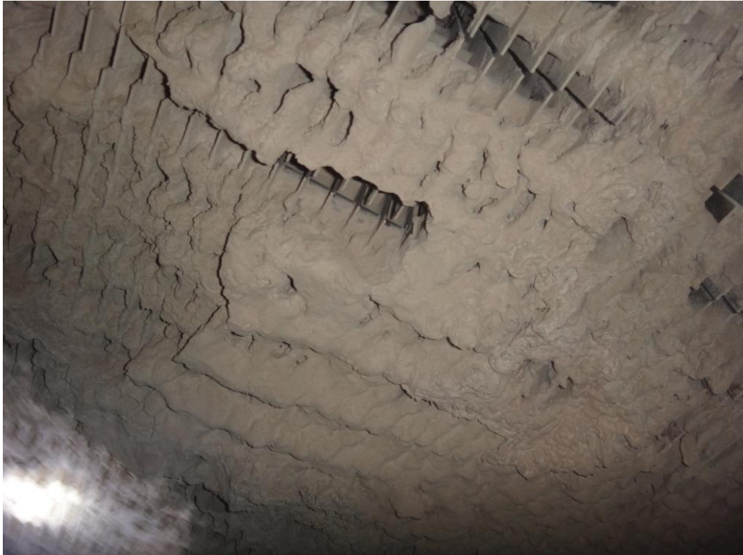
Kuva 24. Ripaputkiekon jättöpuolen aikaisemmasta vuodosta johtuvaa tukkeumaa
