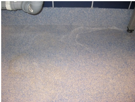
KUVA 2: Keittiön vesipisteen alusta (Kuva: Mari Matilainen 2013)
