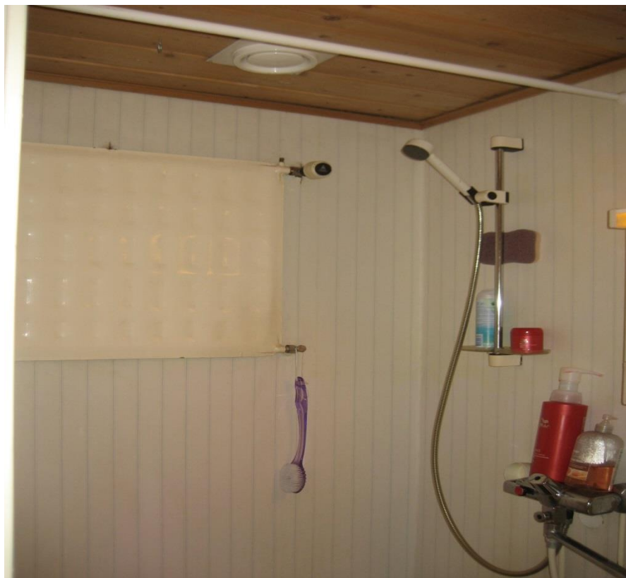
Kuva 1. Yleiskuvaa kylpyhuoneen sisäpinoista huoneistosta C 60.
