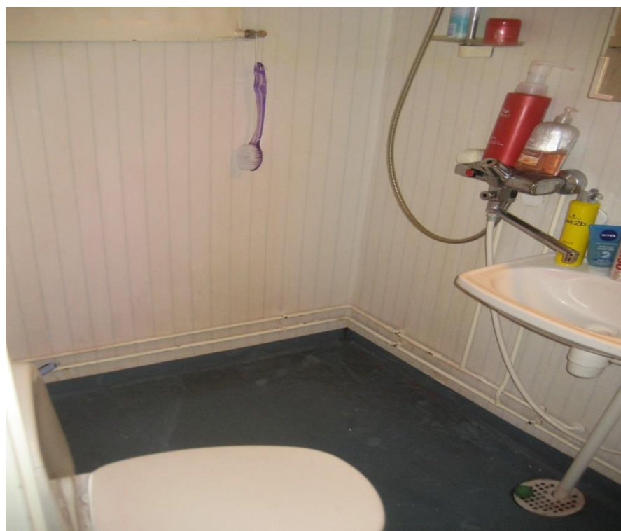
Kuva 2. Yleiskuvaa kylpyhuoneen sisäpinoista huoneistosta C 60.
