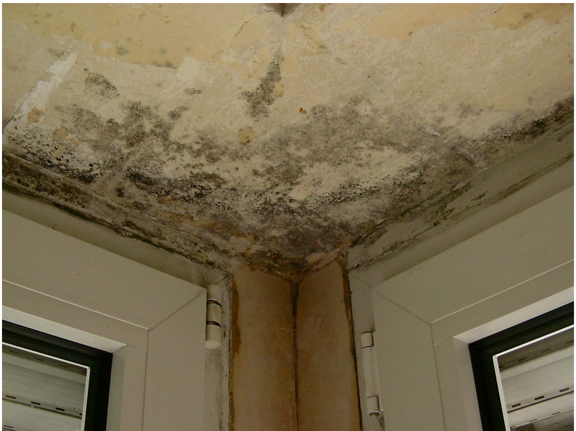
Kuva 6. Hometta katossa ja seinien nurkkauksessa. [36.]
