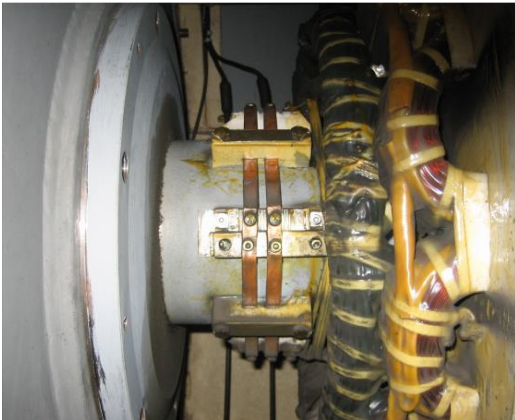
Kuva 11. G5 magnetintiodien kiinnitys kunnossa
