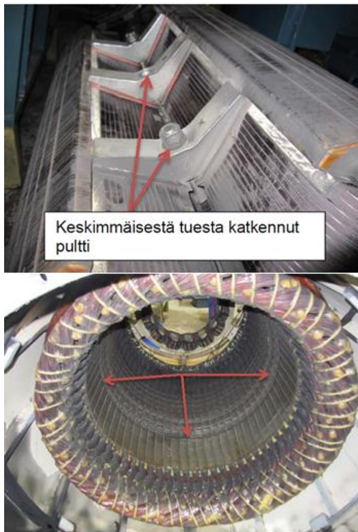
Kuva 25. Katkenneen pultin aiheuttamaa tuhoa
