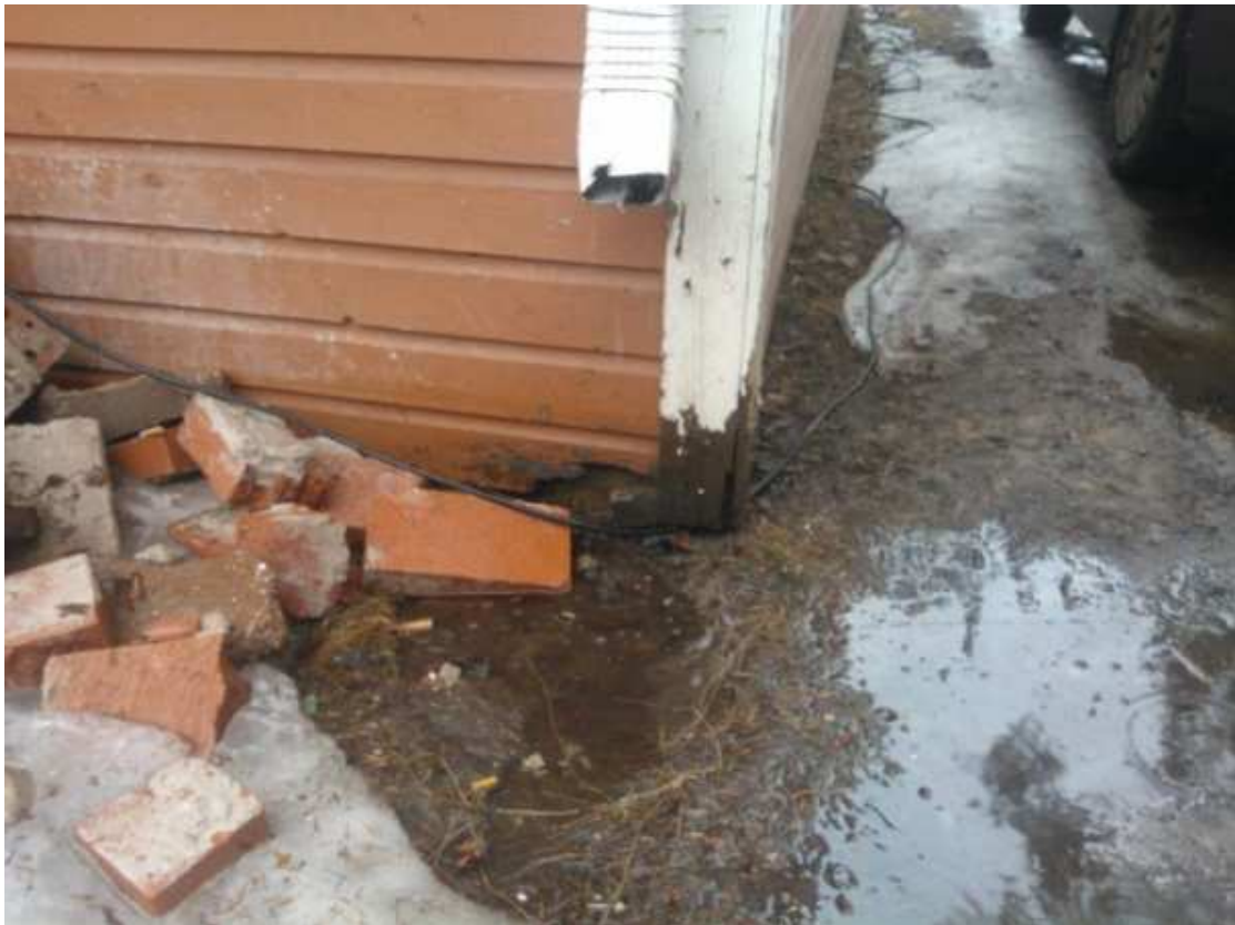
KUVA 12. Laajennusosan lahovaurio ja rakennusjätettä
