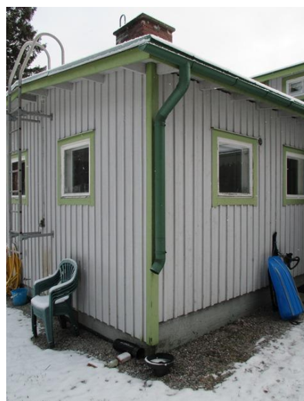
Bild 22. Det fuktskadade hörnet från utsidan. (Bild Jonas Lindqvist)
