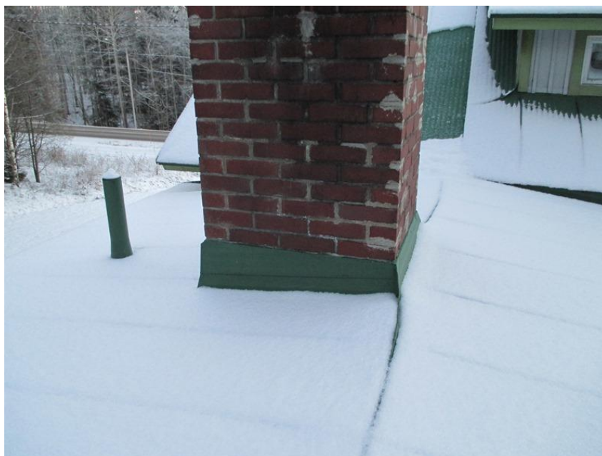
Bild 16. Skorstensgenomföringen utifrån. Genomföringen är inte tät vilket leder till att vatten kan tränga in i konstruktionerna. (Bild Jonas Lindqvist)
