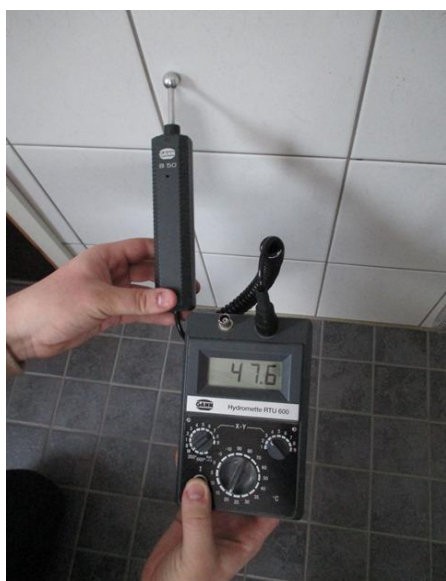
Bild 21. Analys av konstruktionen med en fuktindikator. (Bild Jonas Lindqvist)
