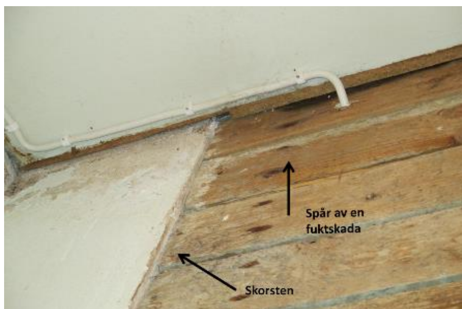
Bild 17. Mellanväggen vid källartrappan. Vattnet som läckt in genom genomföringen har runnit ned längs med skorstenen och orsakat fuktskador på väggen. (Bild Jonas Lindqvist)
