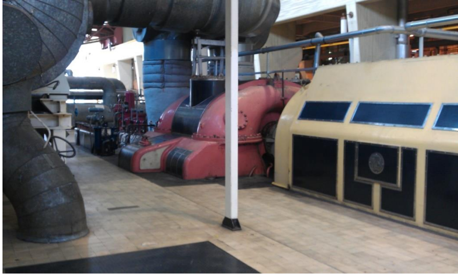
Kuva 3. Vanajan höyryturbiini (punainen kuori) sekä sen akselilla oleva sähkögeneraattori (keltainen kuori) (kuva T. Koivikko, 2011).
