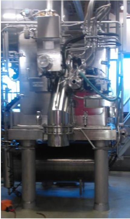
Kuva 11. Moduli 4 linko laitteistoineen.
