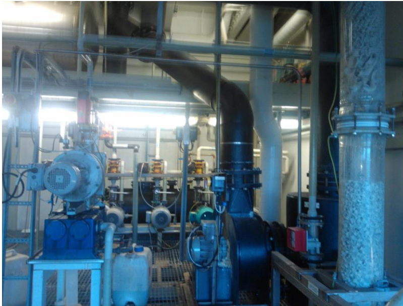
Kuva 14. Kuva tehtaan vanhan puolen vakumi ja hönkälaitteistosta.
