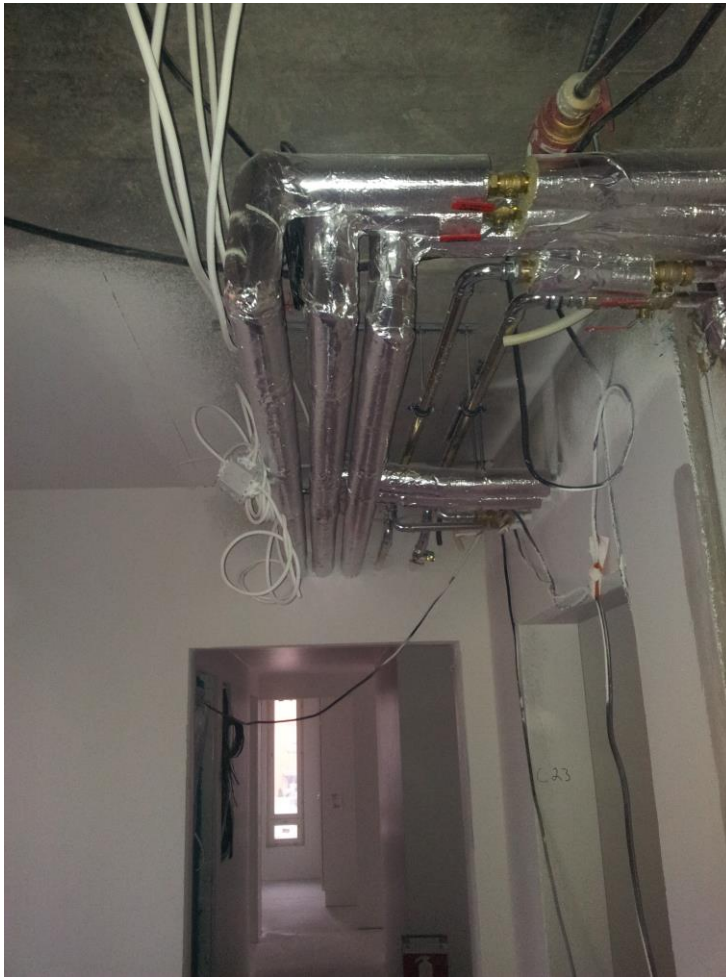
Kuva 9. Eristettyjä LV-putkia katossa. Kuva: Aleksi Valli
